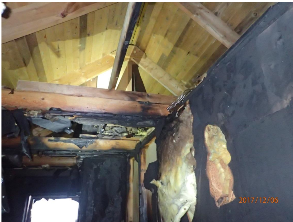
Bild 4 Visar begränsad brand- och rökspridning till vinden. Innertak och isolering är avlägsnat.
