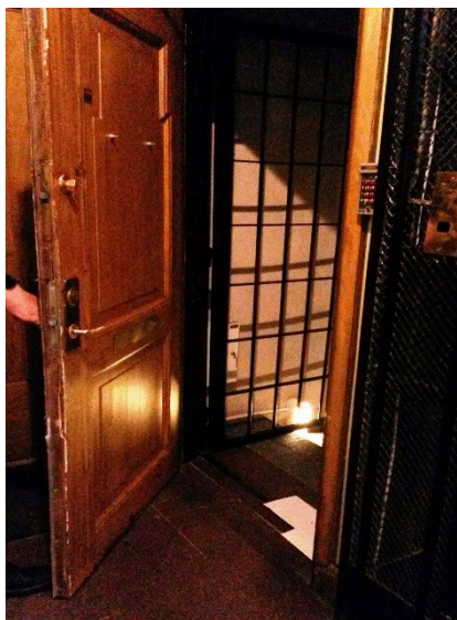
Bild 3. Dörr och gallergrind ner till källaren. Det var här den största rökspridningen skedde.
