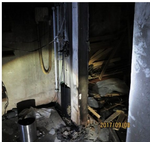
Bild 1. Fläkten där branden troligen startade.
