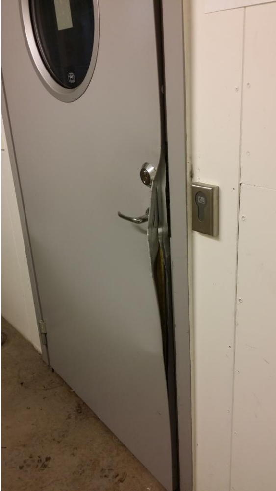
Dörr till tvättstuga som bröts upp vid insatsen.
