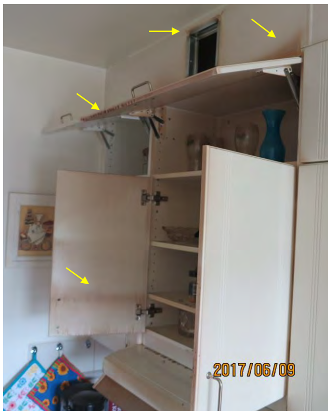
Kök våning 9. Tecken på värmepåverkan och rökspridning kring köksskåp.
