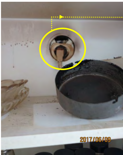
Rökens troliga spridningsväg från köksskåp till skåp under diskho.
