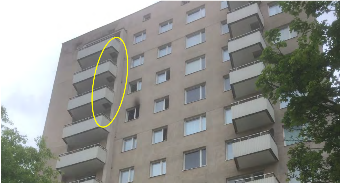
Gul markering visar luckor i balkongerna från våning 10,9 och 8 vars lejdare går till Våning 7
