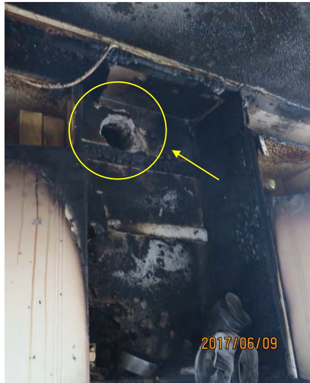
Imkanalens väg in till ventilationsschakt ovanför spisen.
