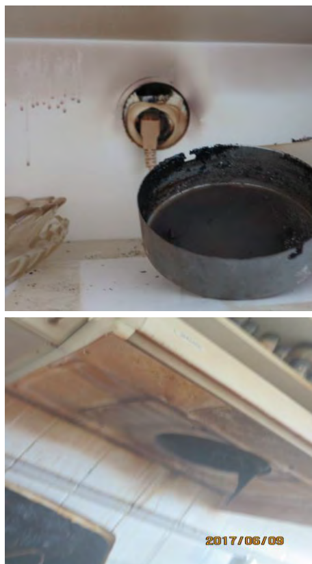
Inspektionsslucka, smält el-installation och köksfläkt
