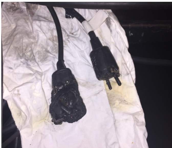
Brandutsatt kabel (foto Stadsteatern)
