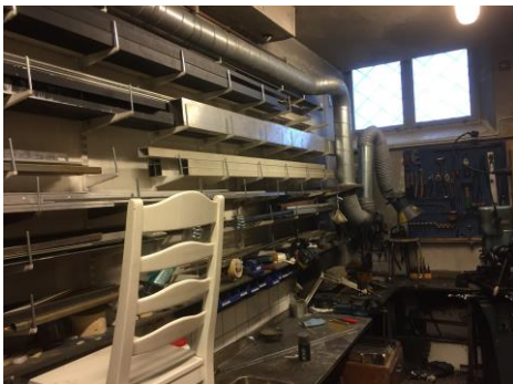
Ventilationsrör från arbetsbänk
