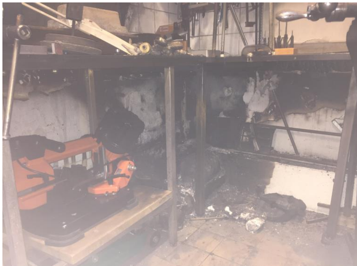
Initialbrandens position under arbetsbänk
