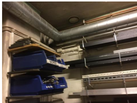
Rörets genomföring via andra utrymmen
