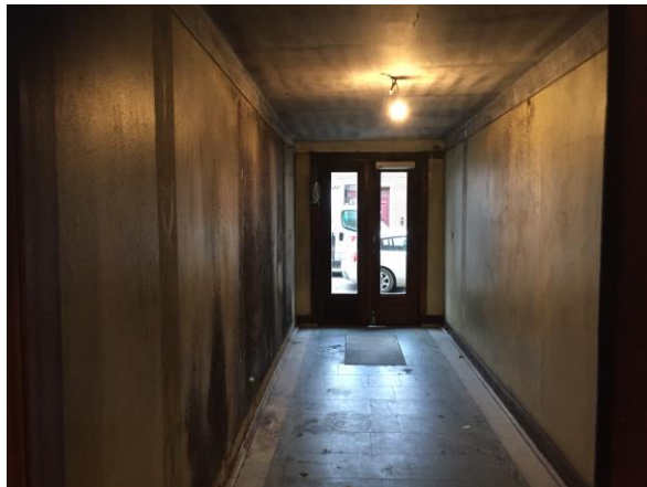
Brandens position sett från trapphuset
