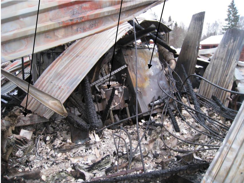
Matarrör från flisficka Brännare Panna med tillhörande skorsten
