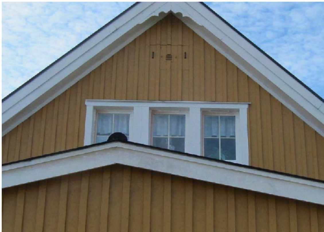
Bild 8: Här syns att fönsterbågarna blev svedda på grannfastigheten.
