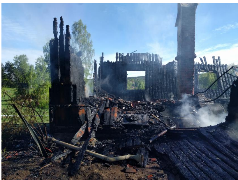
Byggnaden helt nedbrunnen
