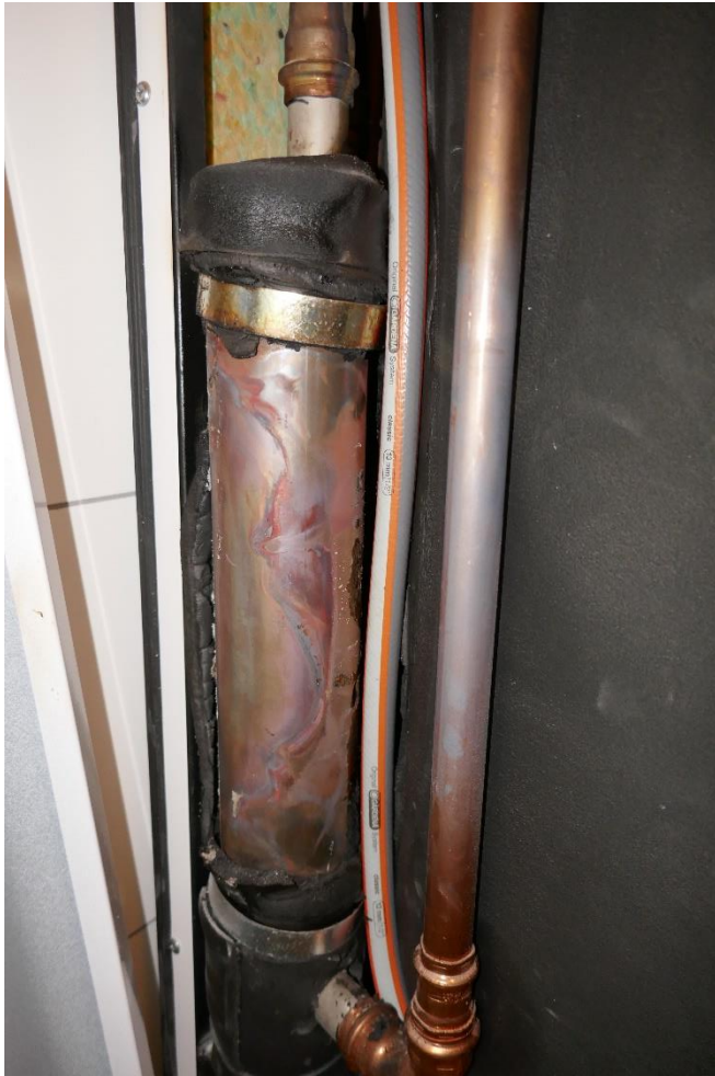
Foto 3 visar bortbränd isolering
