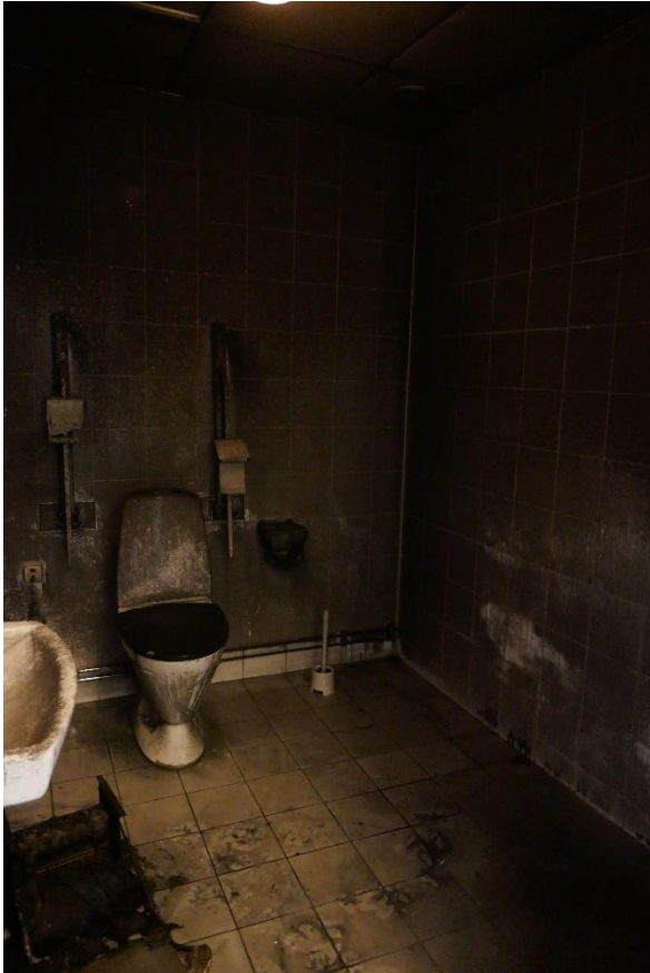
Foto 3 skador på toaletten
