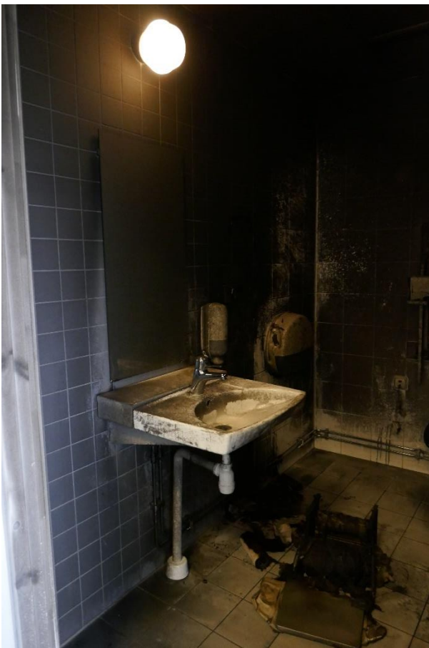
Foto 2 skador på toaletten
