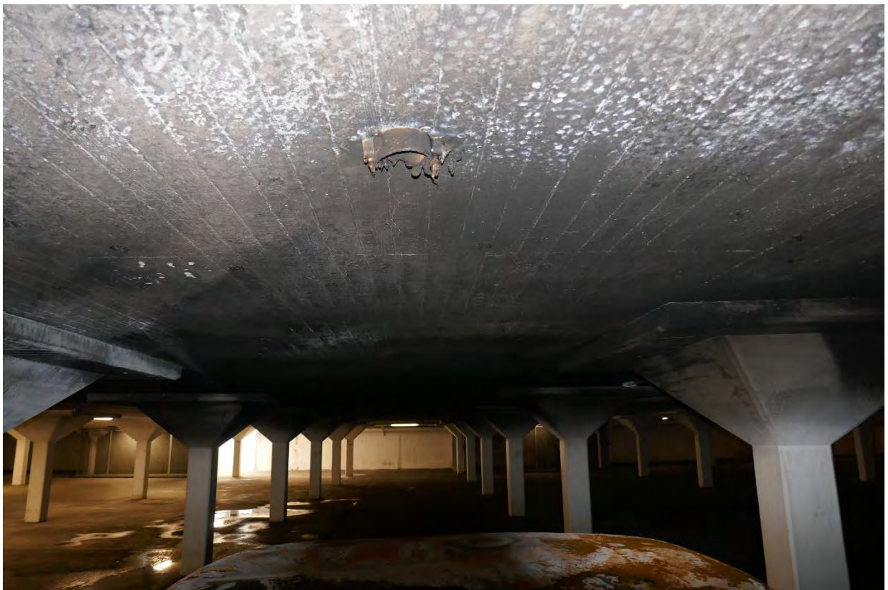
Foto 2, brandskador i tak.
