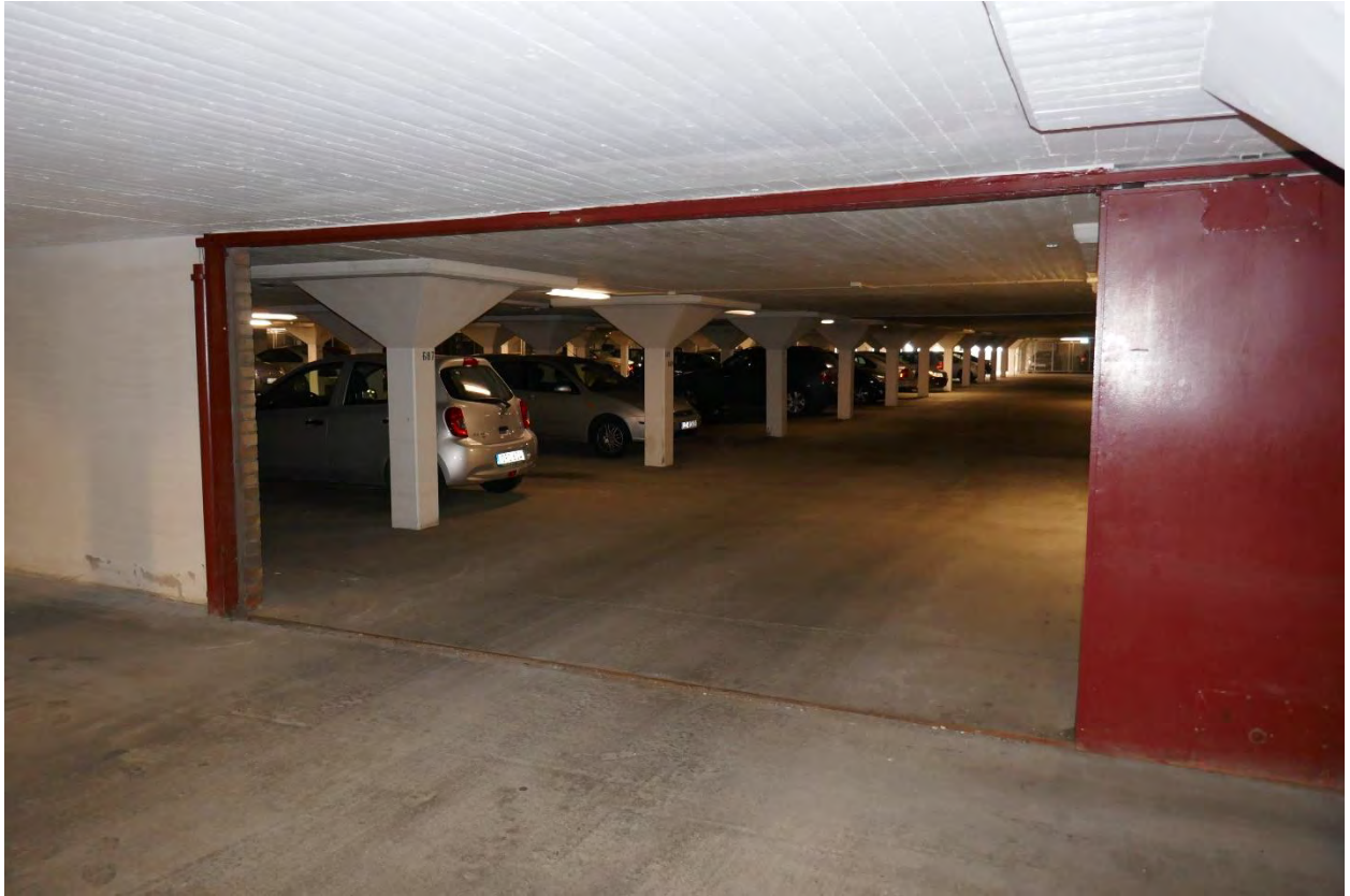
Foto 3, brandskjutport mellan garagedelarna.
