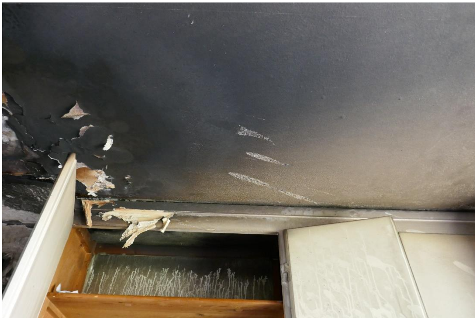
Foto 2 visar skador i köket
