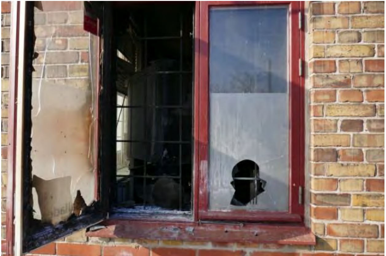
Bild 3. Det krossade fönstret intill köket på den östra delen av byggnaden.
