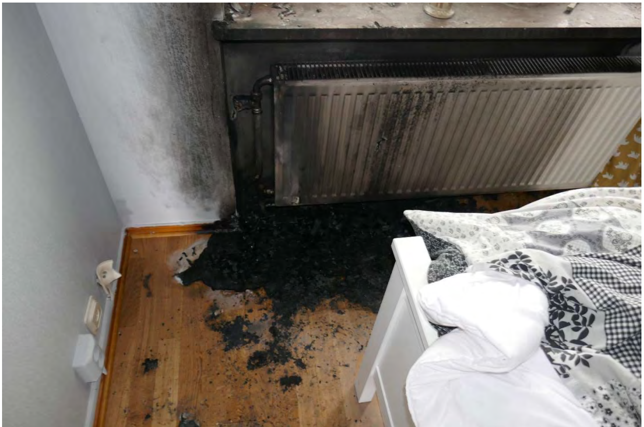
Foto 3. Brandskador på vägg och golv i sovrummet.
