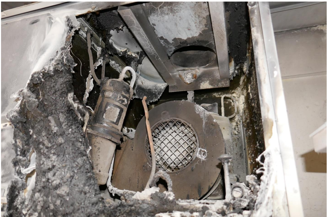
Foto 2, brandskada inne i värmepumpens övre del
