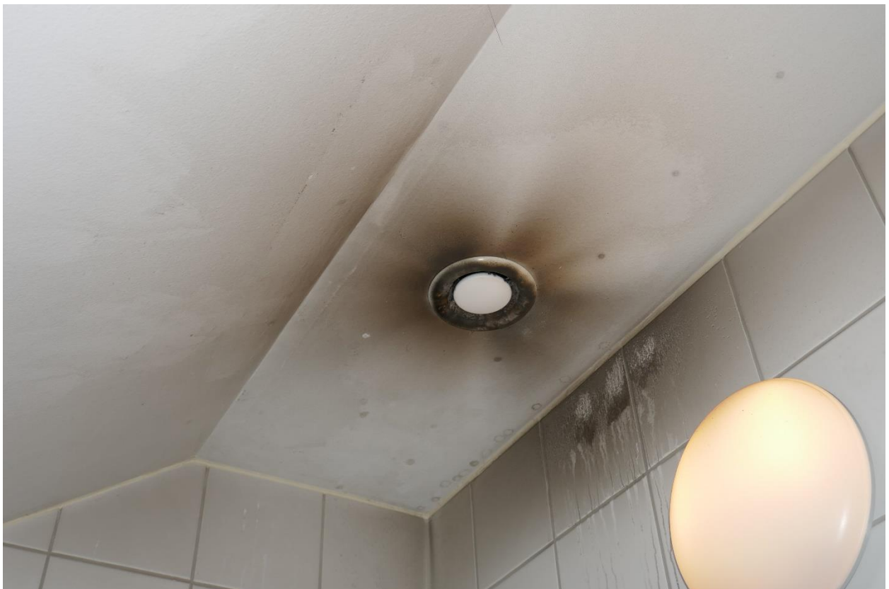
Foto 4 visar rökskador efter spridning in till ett badrum i den mindre av de två lägenheterna på andra våningen.
