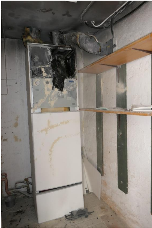
Foto 1, den brandskadade värmepumpen
