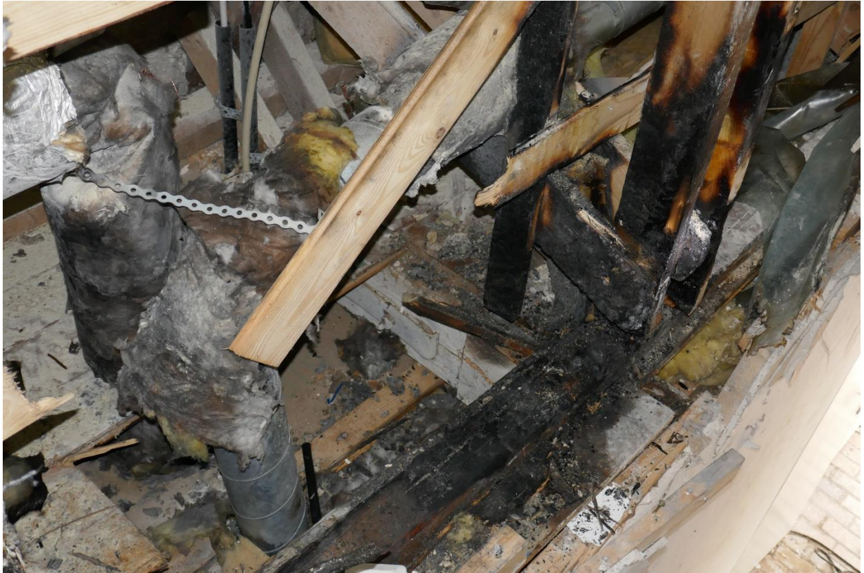
Foto 3 brandskador i konstruktionen ovanför värmepumpen
