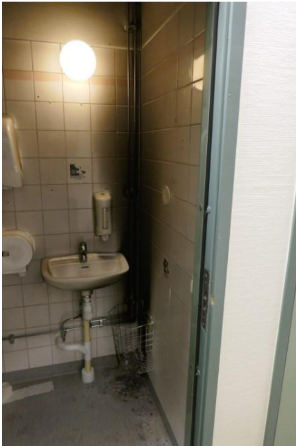
Bild 2. Brand- och sotskador väggar och golv.
