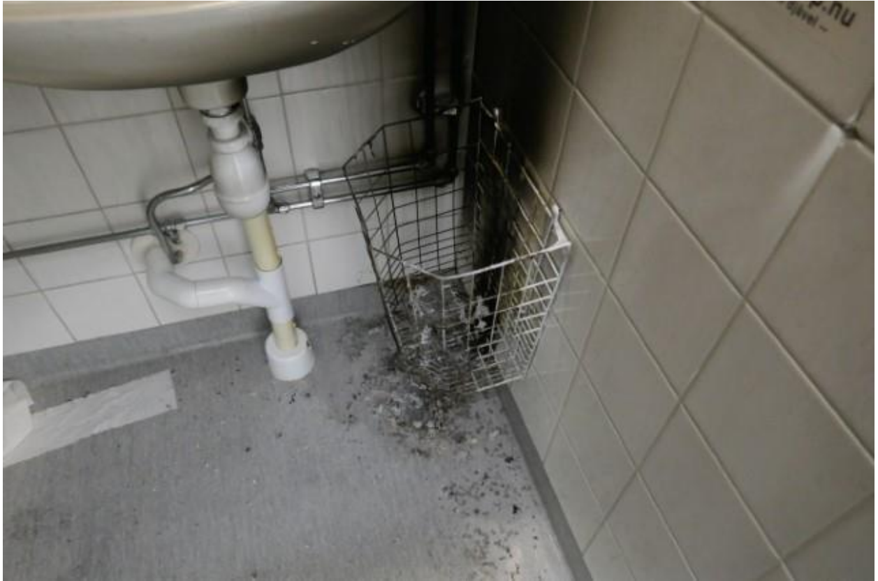
Bild 3. Brand- och sotskador på vägg och golv.
