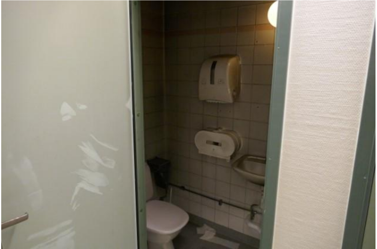
Bild 1. Sotskador på toalettdörren och väggar.
