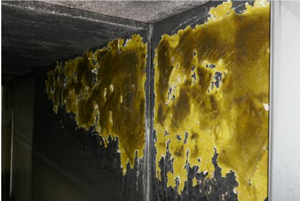
Foto 3. Färg på väggarna som har lossnat vid branden.
