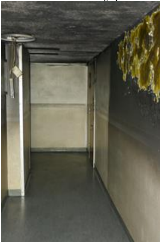
Foto 2. Brand- och sotskador på väggar och tak i trapphuset.
