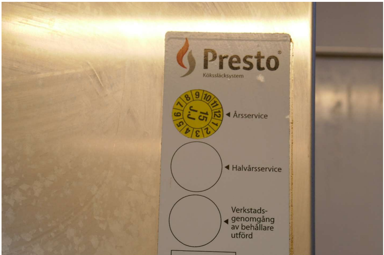
Bild 3. Kontroll gjord på sprinkleranläggningen i december 2015.
