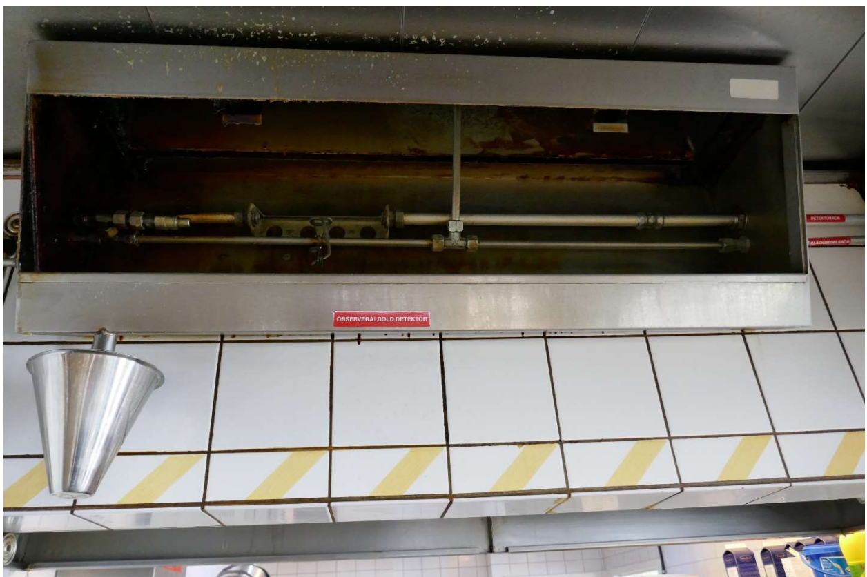
Bild 4. Smältsäkringar som sitter dolda bakom filter, säkringen testades och var fullt funktionell.
