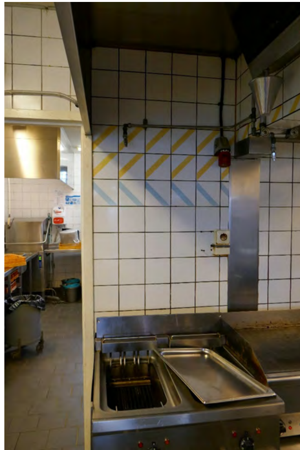
Bild 2. Sprinklermunstycke ovanför fritösen.
