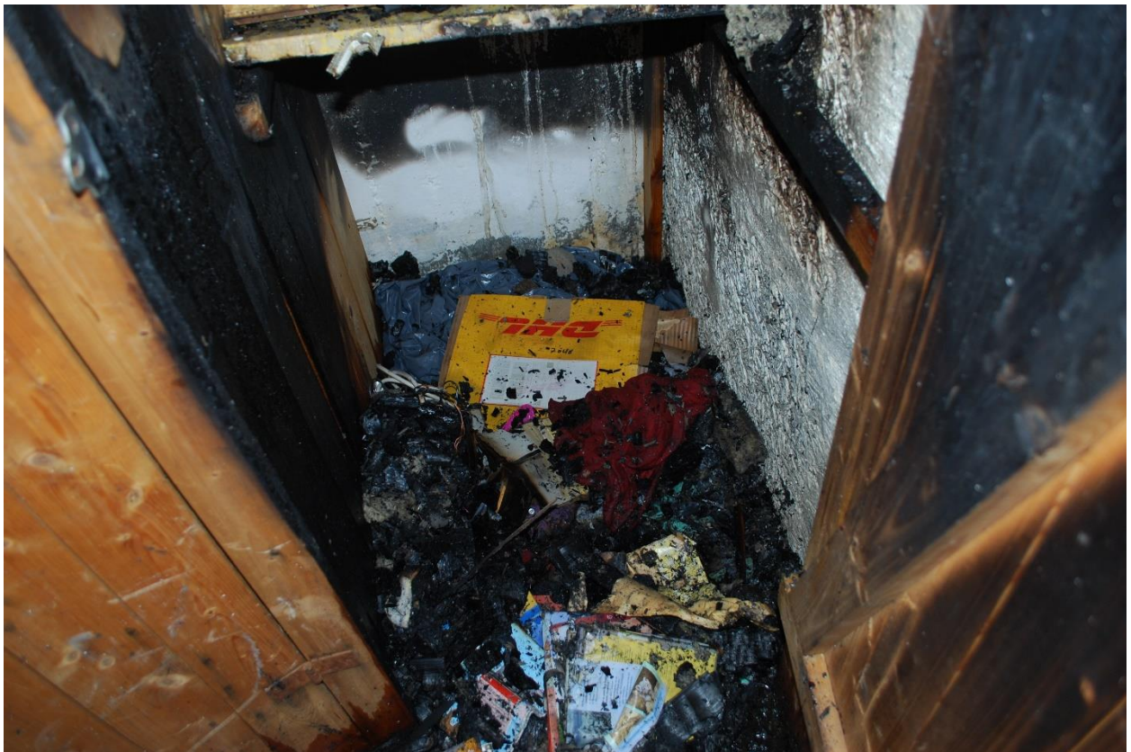
Foto 2, brandskador i förråd.
