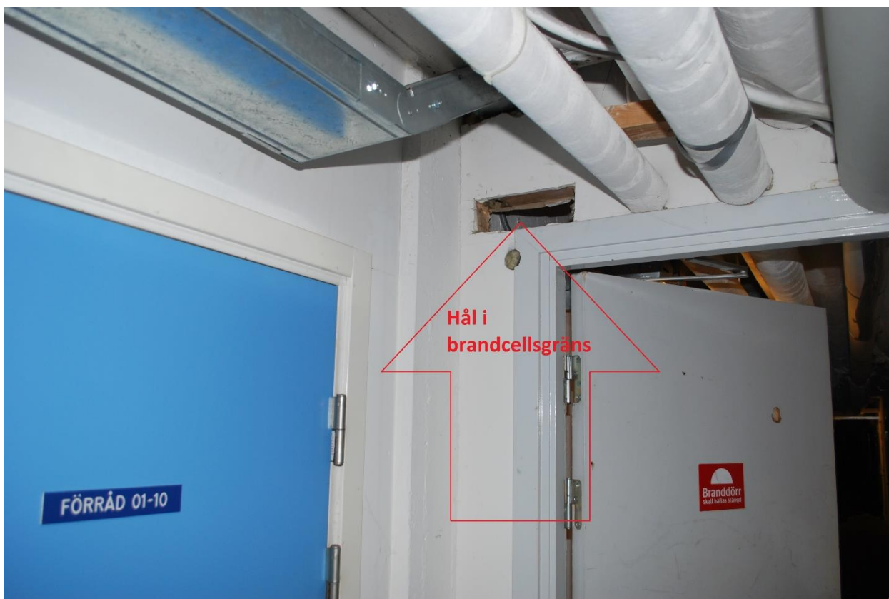
Foto 4, i källaren fanns flertalet hål i brandcellsgräns.
