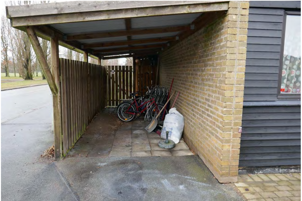
Bild 3. Carporten och husfasaden som klarade sig ifrån skador
