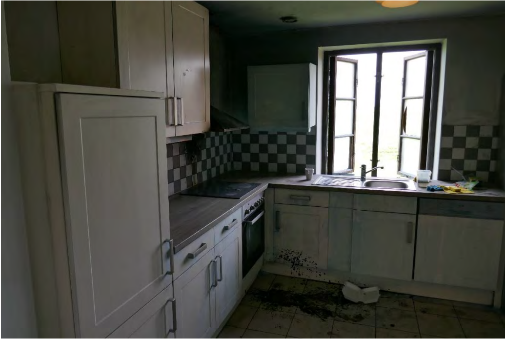
Foto 3. Brandskador på köksgolvet.
