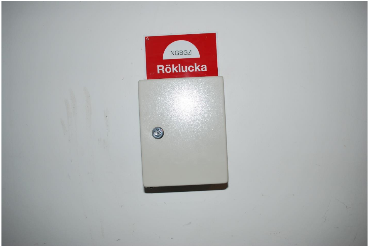
Bild nr 3. Öppningsanordning till röklucka.
