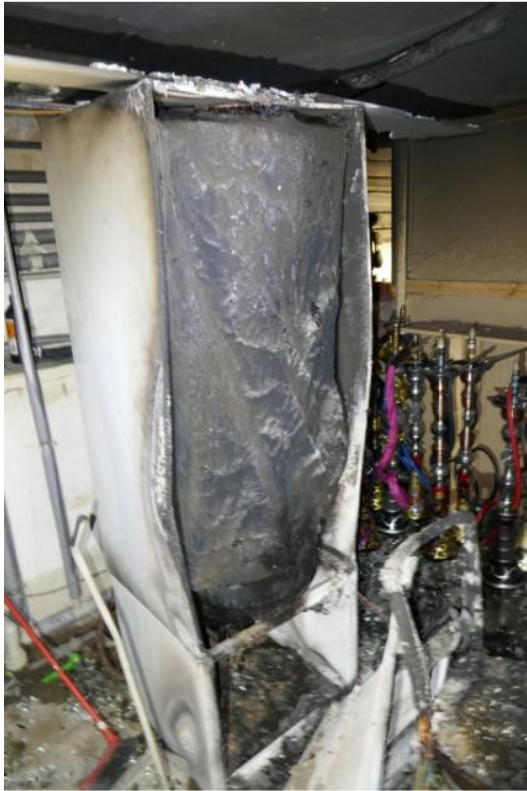
Foto 1. Brandskador på varmvattenberedare.
