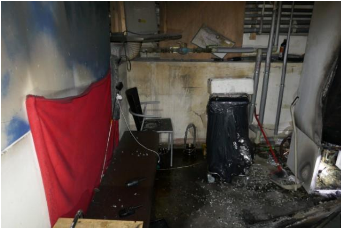
Foto 2. Rök- och sotskador i källaren.
