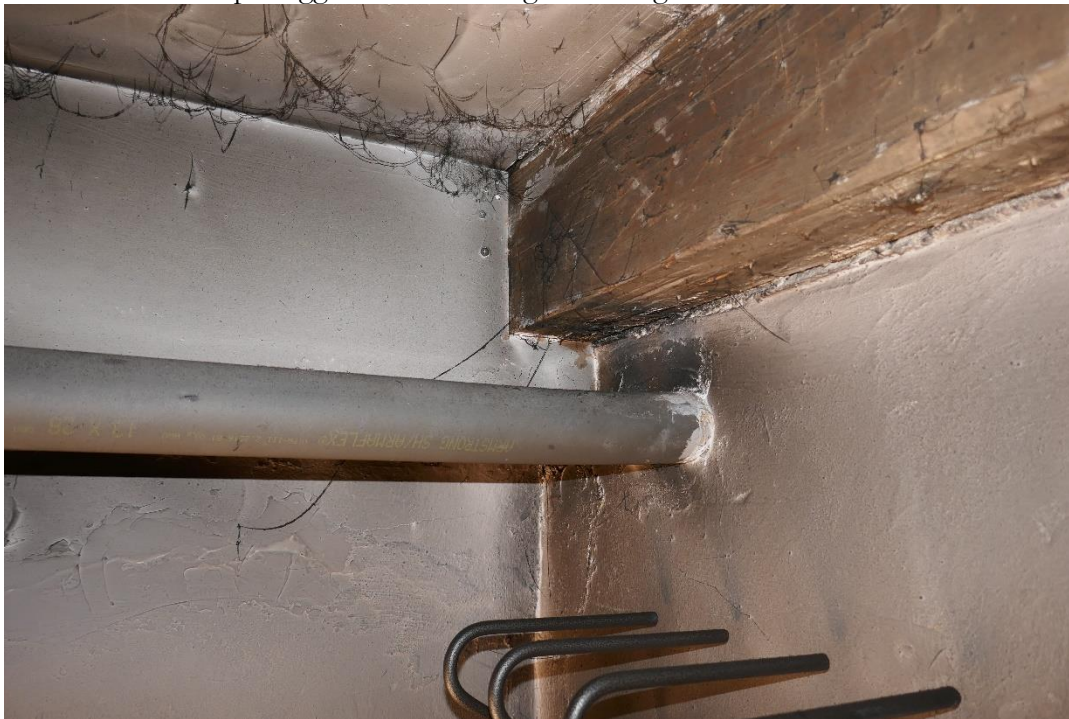
Foto 4. Sotskador på väggar och tak i trappan upp till andra våningen.
