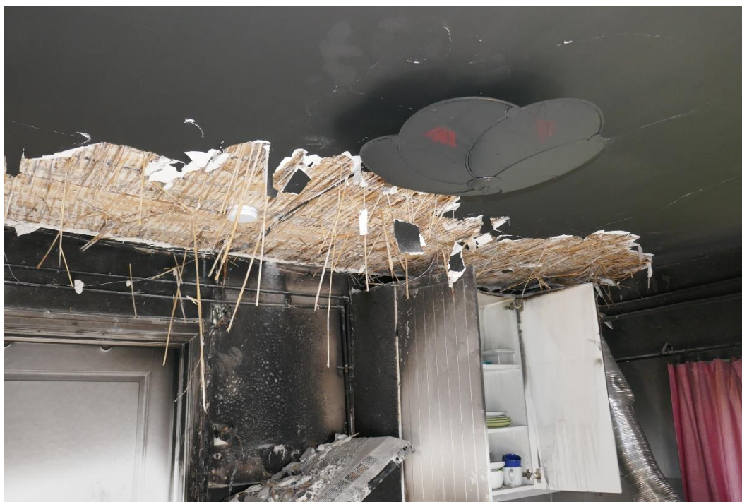
Foto 2. Skador i taket i köket orsakade av räddningstjänstens friläggning för kontroll av brandspridning.
