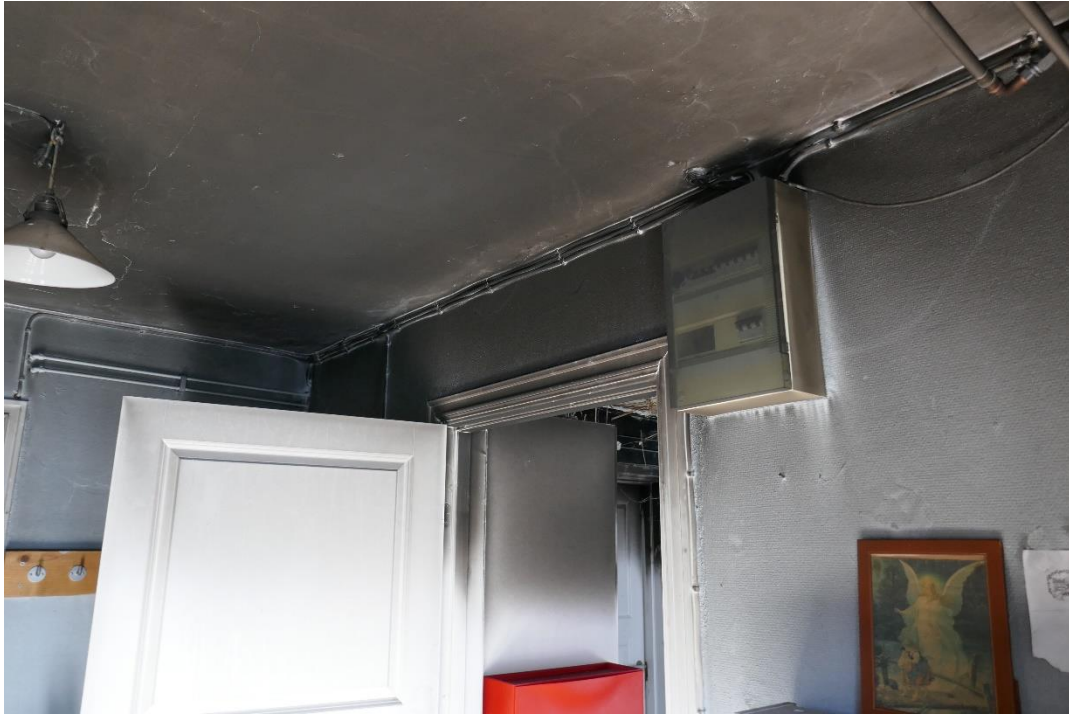
Foto 3. Sotskador på väggar och tak i övriga rum i lägenheten.
