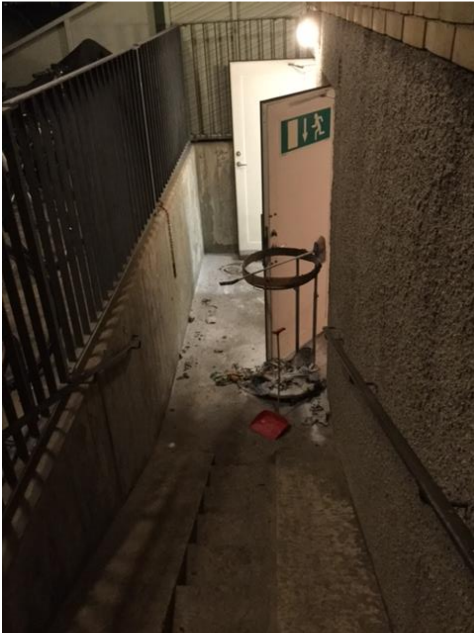
Bild 1. Sophällaren till soppåsen som hade brunnit.
