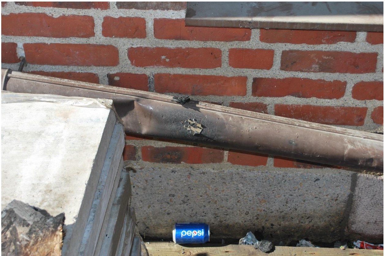
Foto 2. Brandskador på plåtrör.
