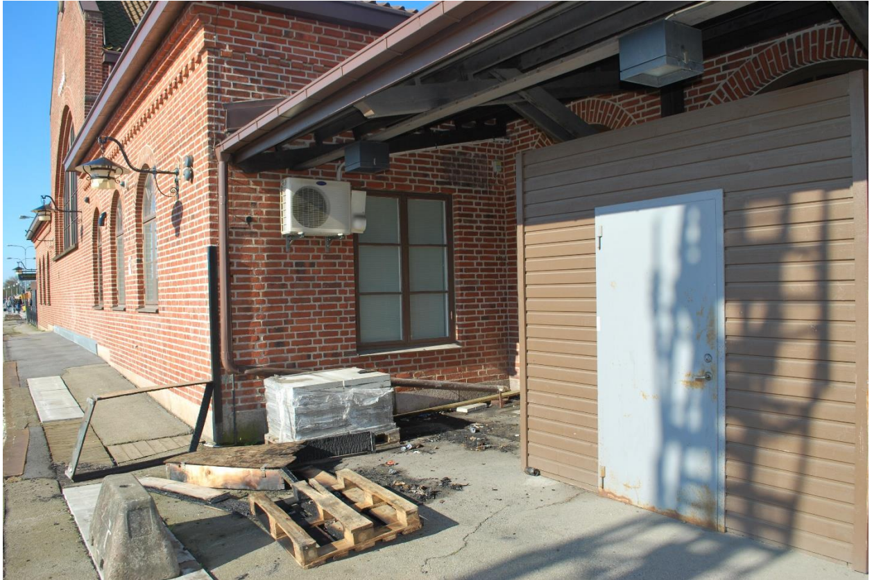
Foto 1. Lastpallen var placerad intill fönstret.
