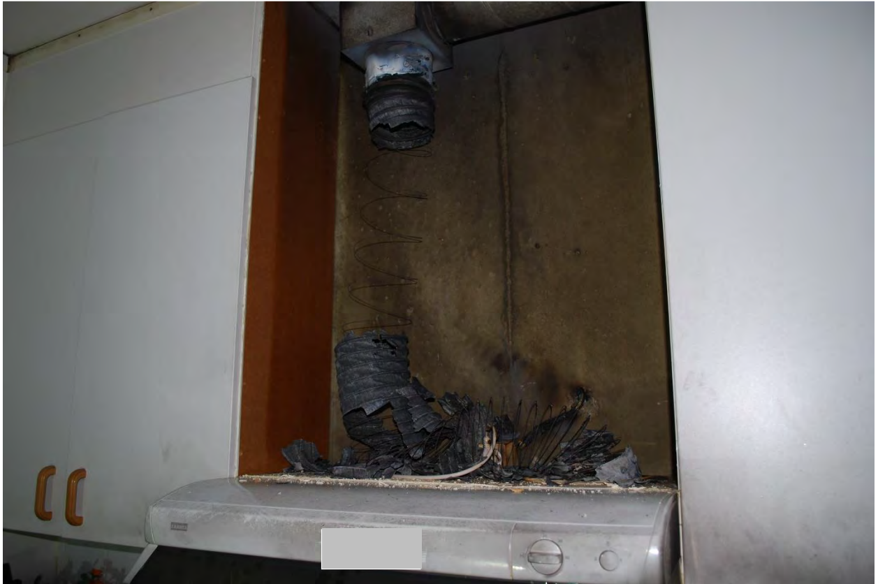
Foto 3, brandskadat rör från fläkten
