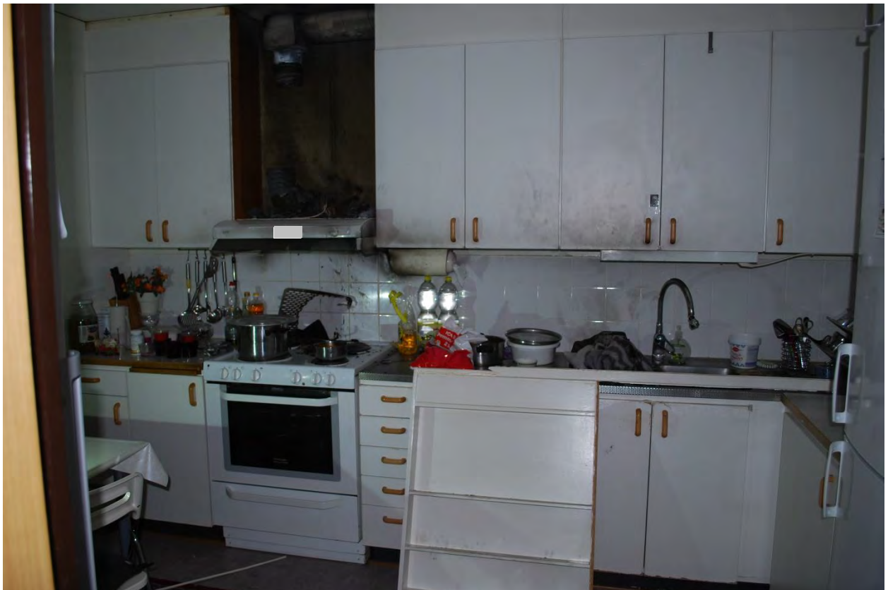
Foto 4, sotskador på skåp och vägg
