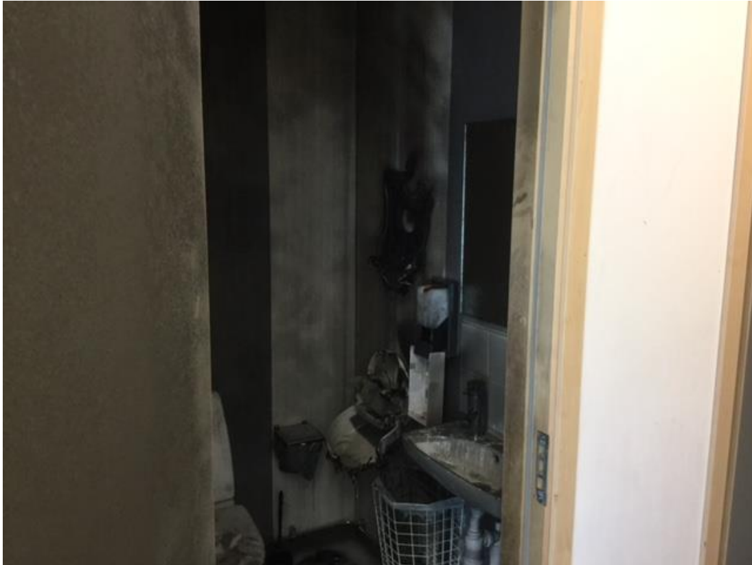
Foto 1. Brand- och sotskador på toaletten placerad på bottenvåningen.
