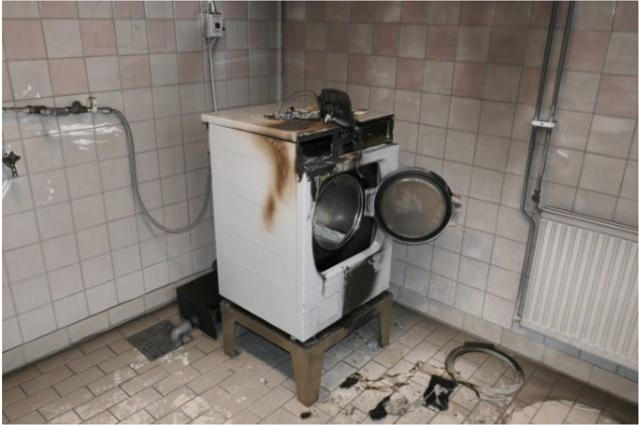
Foto 1. Den brandskadade tvättmaskinen.
