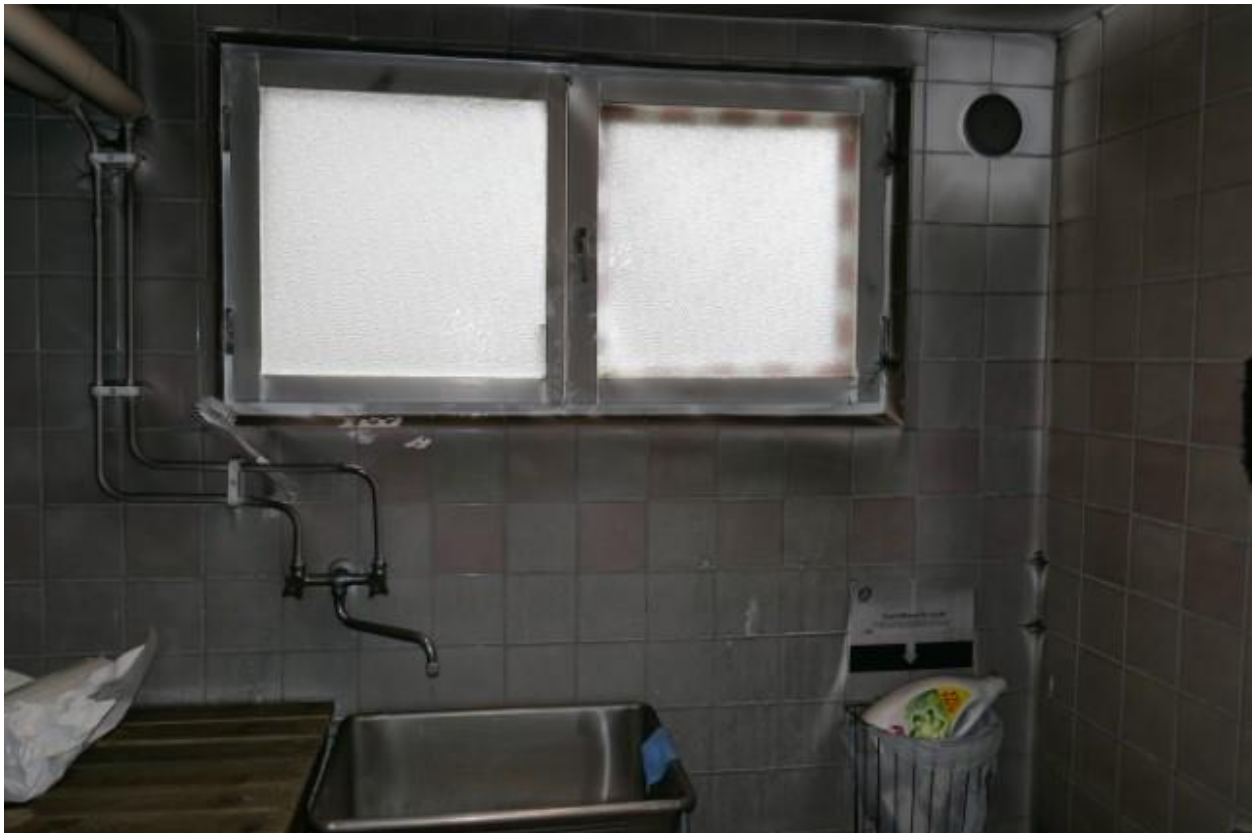
Foto 4. Sotskador på väggarna i tvättstugan.
