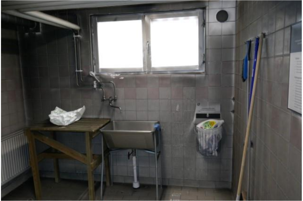
Foto 3. Rök- och sotskador i tvättstugan.
