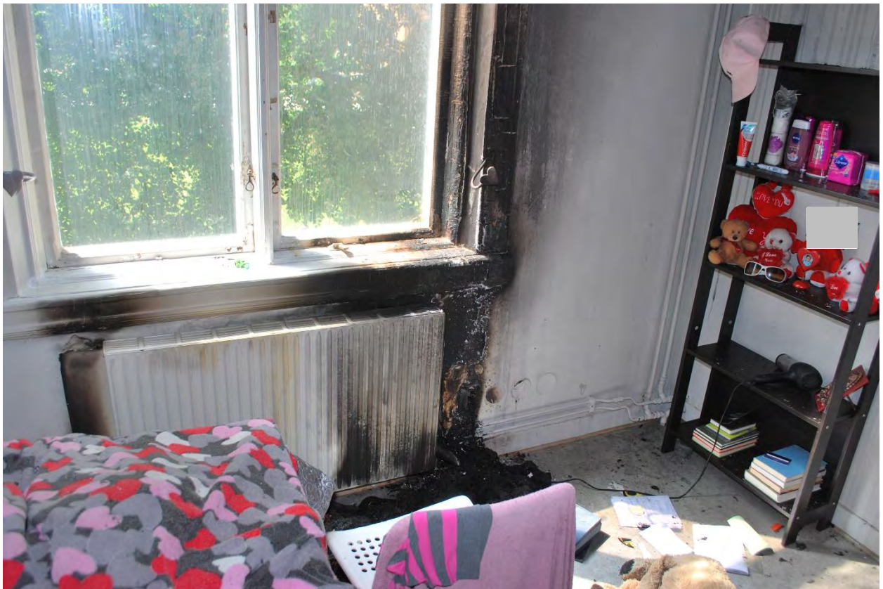
Foto 4, brandskadades golv, vägg, fönsterparti, eluttag och gardin.
