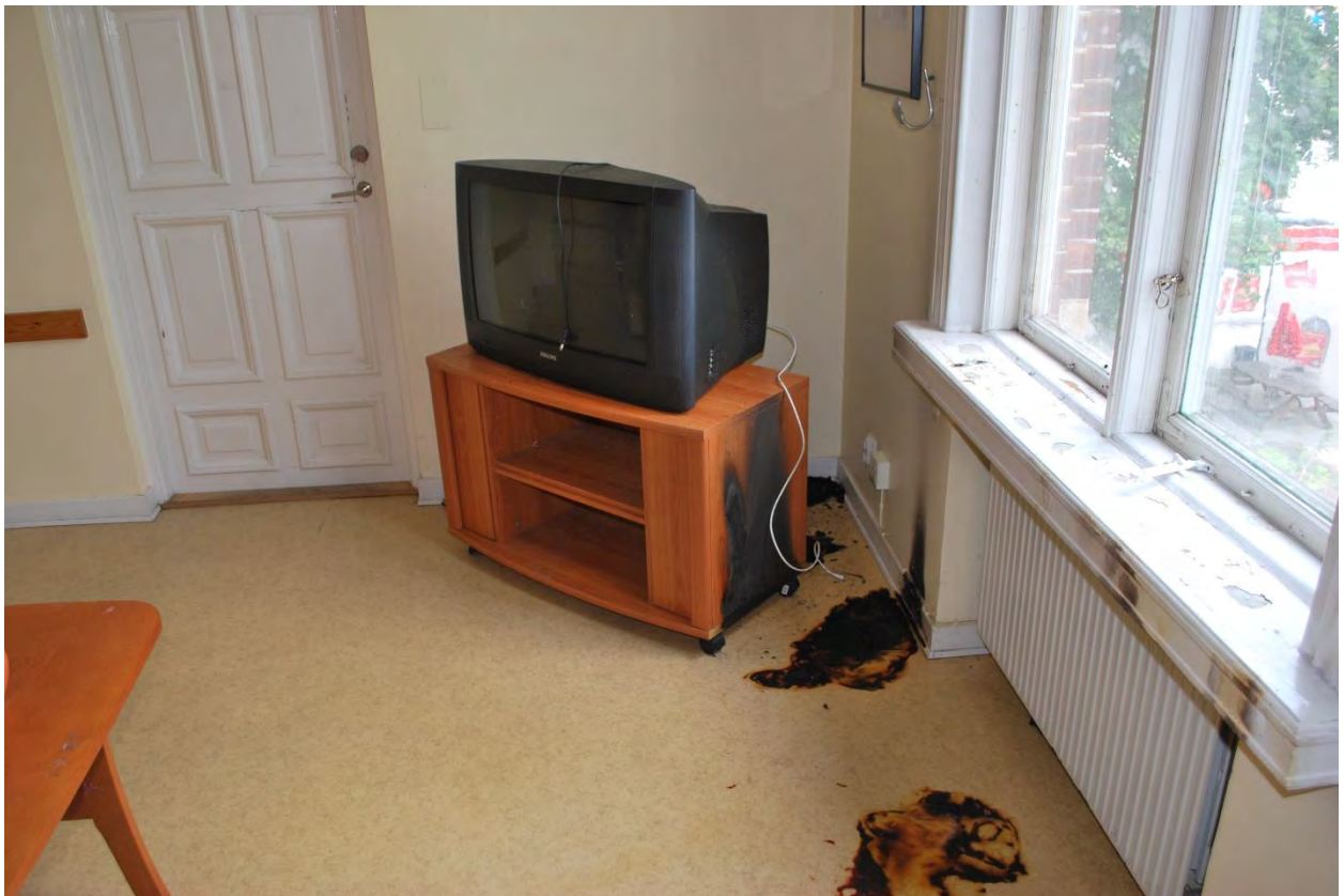
Foto 2, brandskador på golv, vägg, fönsterkarm, tv-bänk och gardin.
