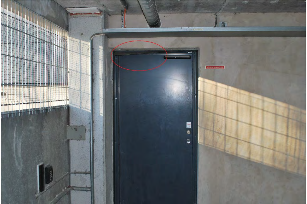
Bild nr 3. Otätheter mellan dörrkarm och vägg.
