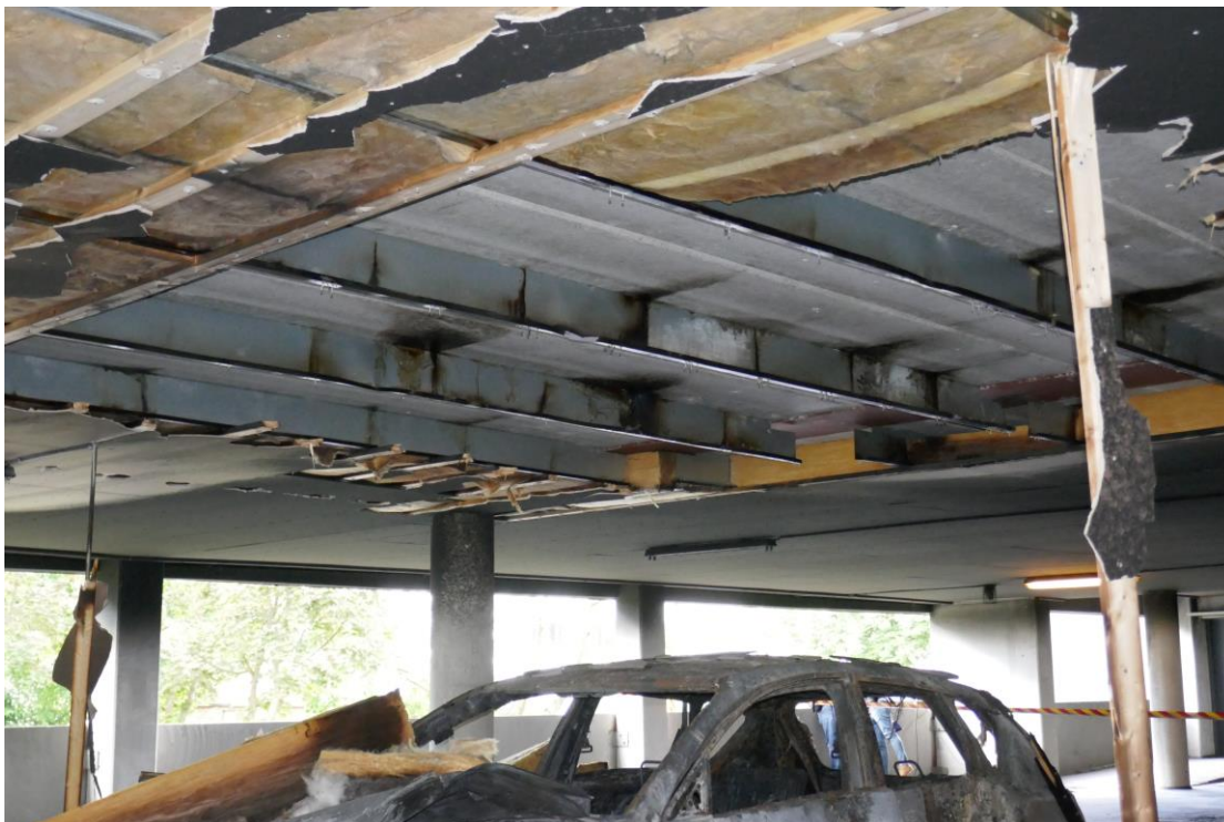
Foto 2. Skador taket efter friläggning av isolering.
