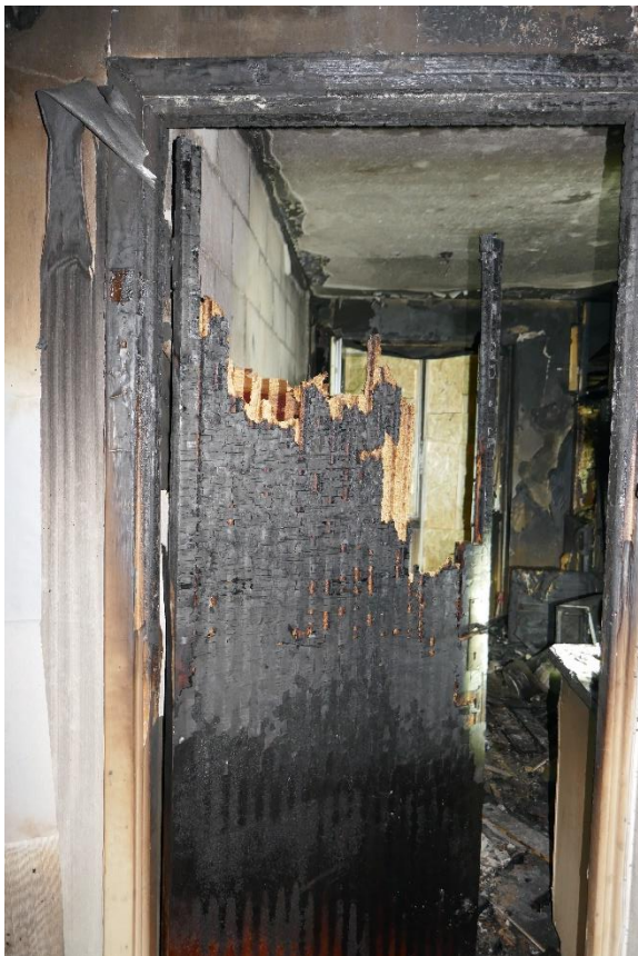
Foto 2 visar brandskador på dörr in till köket samt i köket.
