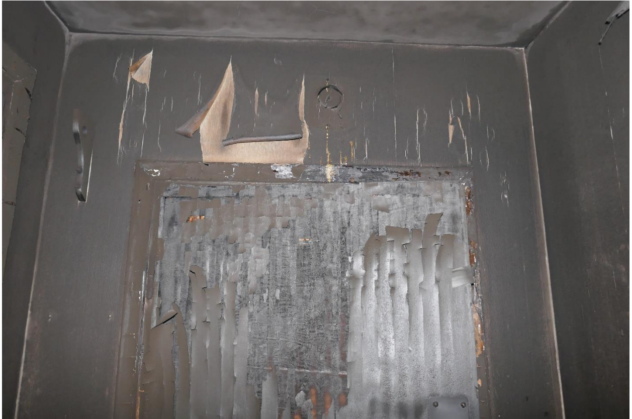
Foto 3 visar brandskador på dörr mot trapphuset.
