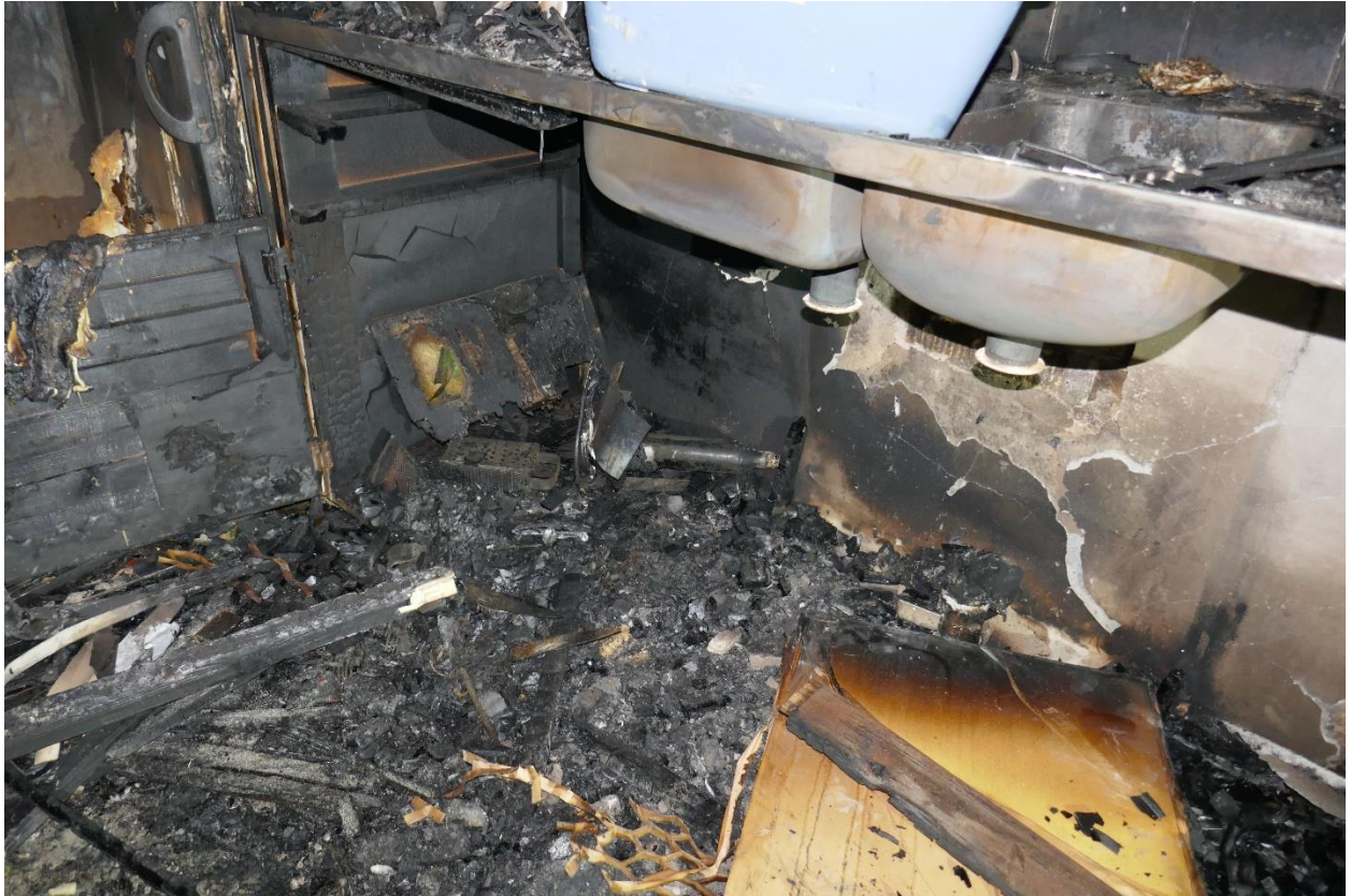
Foto 1 visar brandskador i köket under diskbänk.
