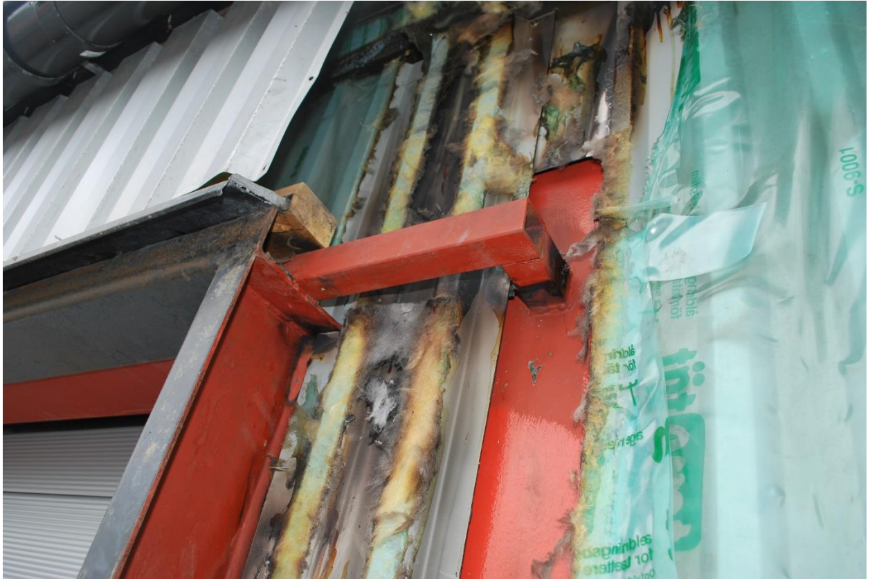
Foto nr 1, brandskadad plåt och avbränd plast.
