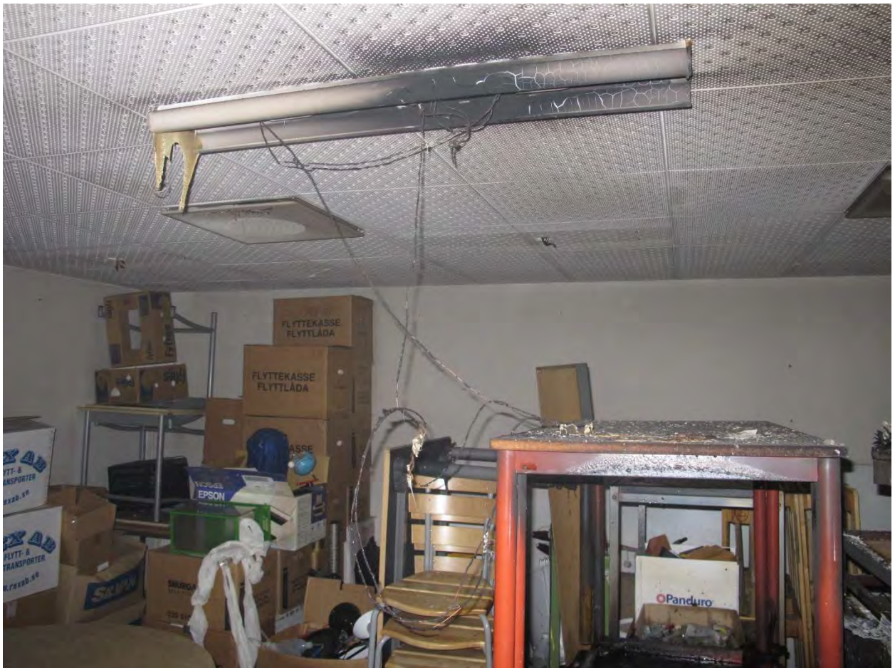
Bild 3. Troliga orsaken är att branden startade i lysrörsarmaturen.
