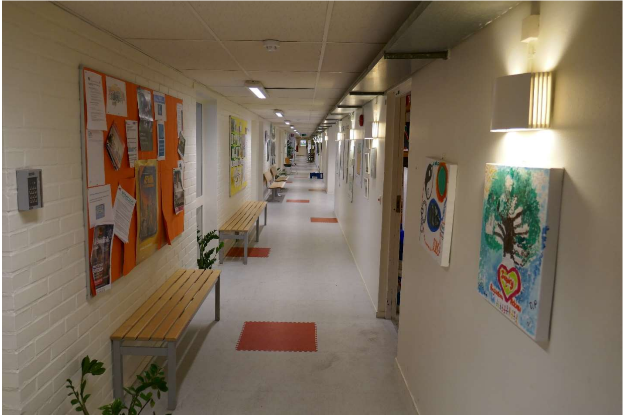
Bild 2. Mindre rökskador i korridoren utanför förrådet.
