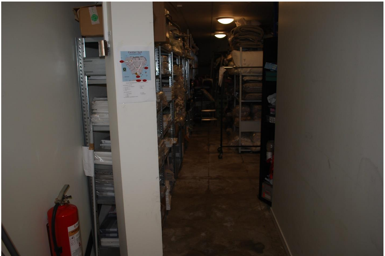
Foto 2. Lagret på Hemtex har fått vattenskador i väggarna.
