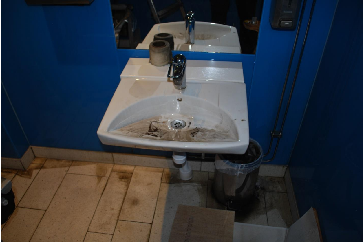
Foto 1. Brand i handfatet inne på toaletten.
