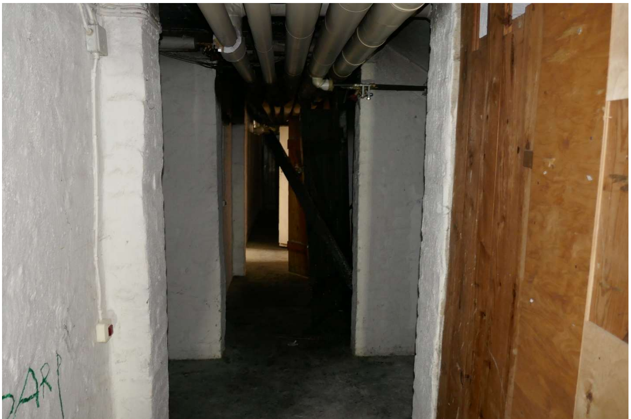
Bild 2. Mindre sot/rökskador i källaren på Osbygatan 16A-B.
