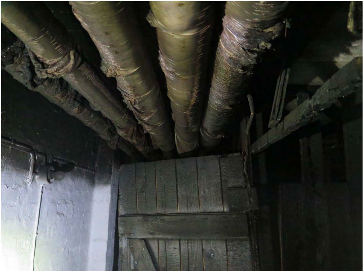
Bild 4. Värme, vatten och avloppsrör fick brandskador.
