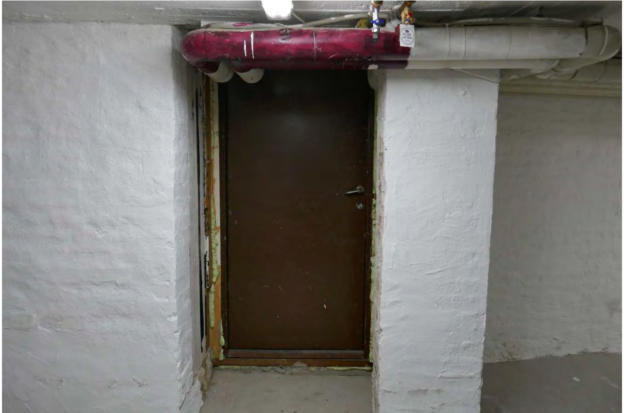
Bild 3. Rök ventilerades ut från källaren på Ystadsgatan 34.
