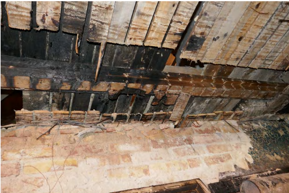
Foto 5. Brandskador på takbjälkar och golvbräder till vinden.
