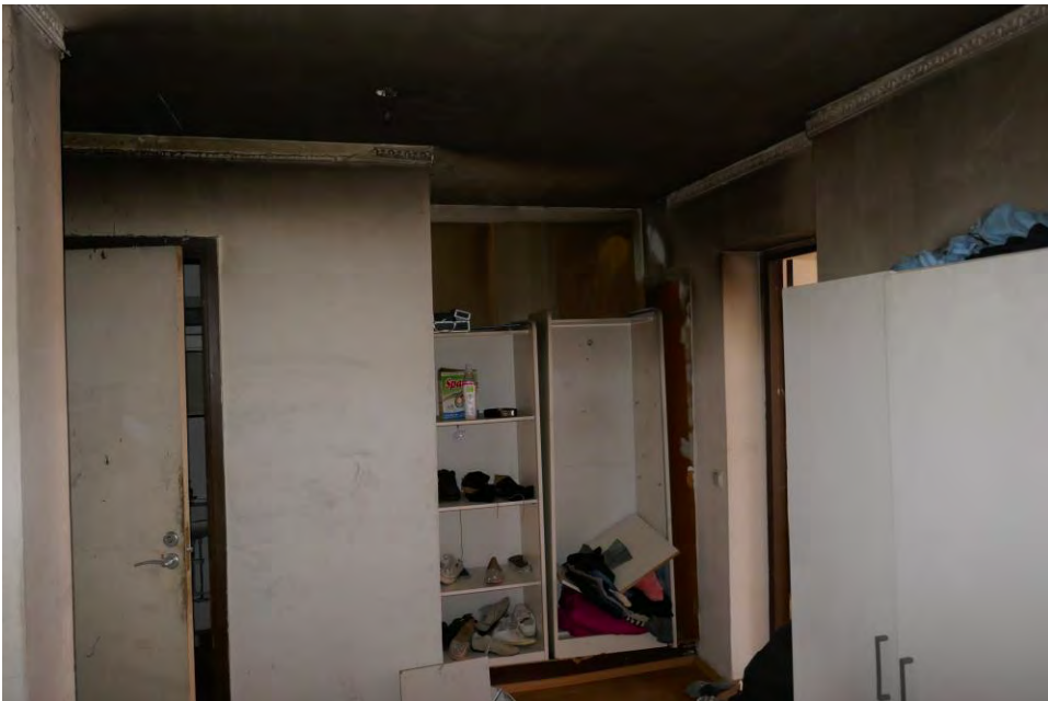
Foto 3. Rökskador i taket i hallen utanför köket.
