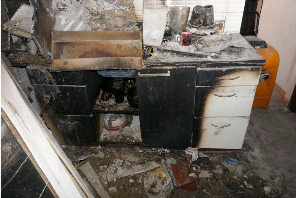
Foto 2. Brandskador på köksinredning.
