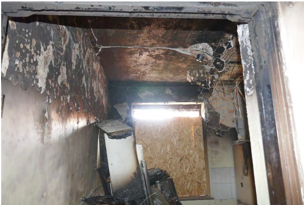
Foto 1. Brandskador i taket och förspikat fönster i köket.
