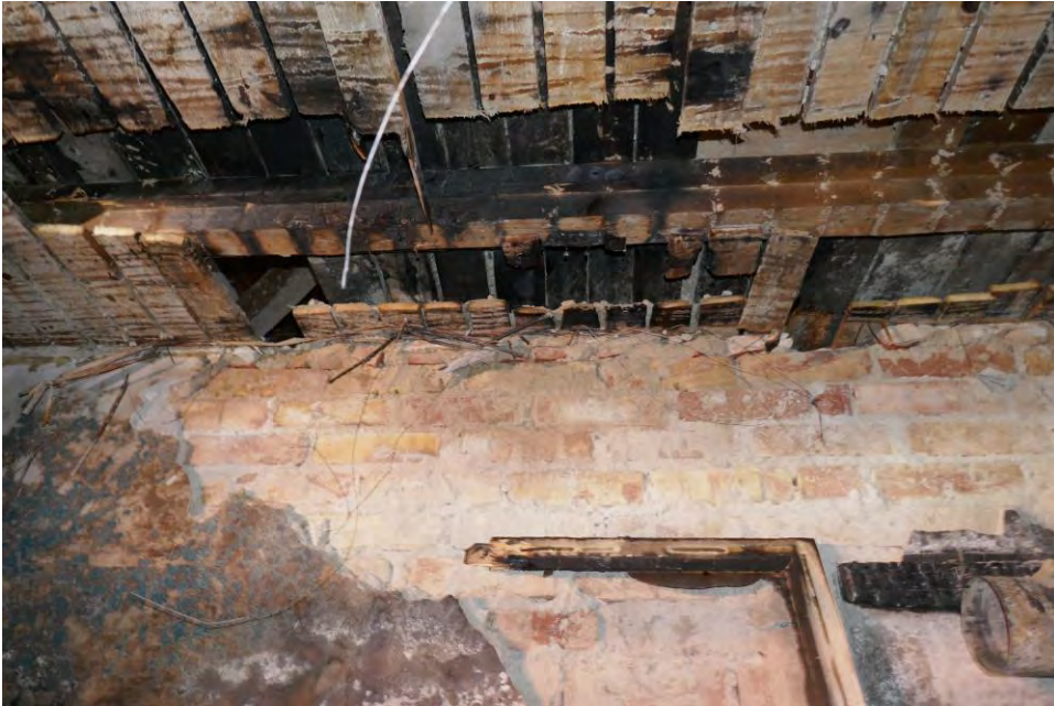
Foto 4. Brandskador på takbjälkar upp till vinden.
