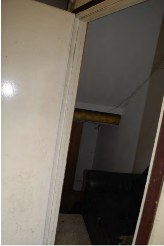
Foto 5 visar nedgång till boende i källaren, soffa står precis innan för dörren (brännbart material i utrymningsvägen samt blockerar i utrymningsvägen)
