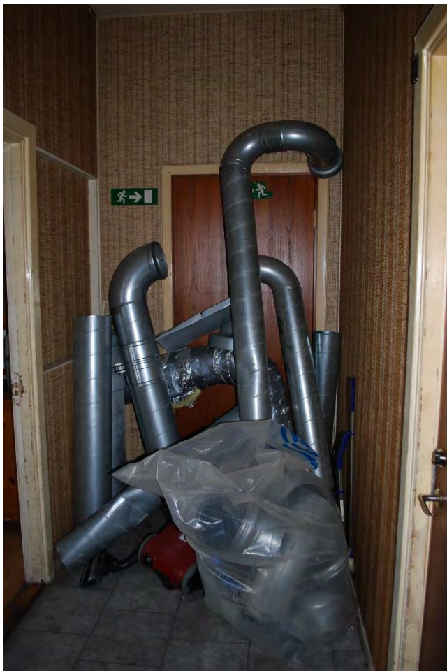
Foto 4 blockerad utrymningsväg från föreningslokalen
