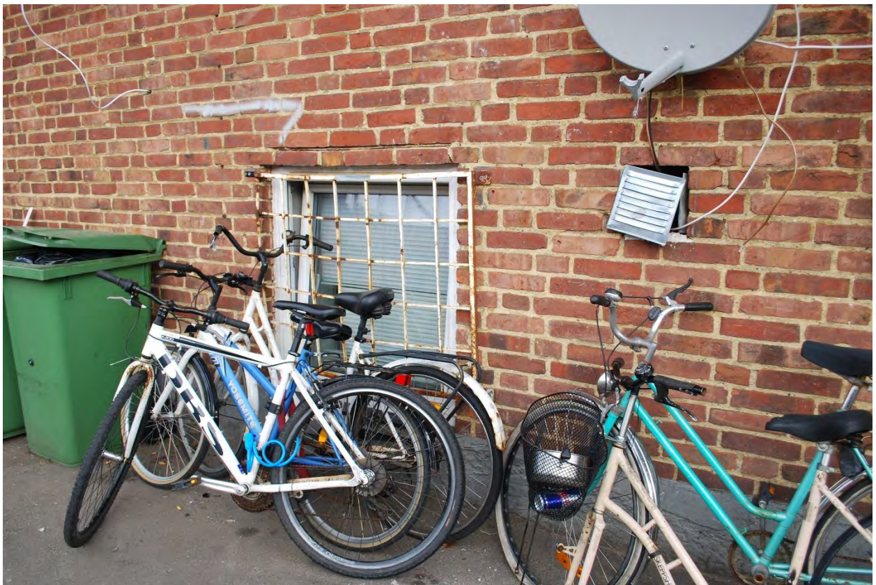
Foto 6 visar hur den alternativa utrymningsvägen från källaren är blockerad av galler samt cyklar
