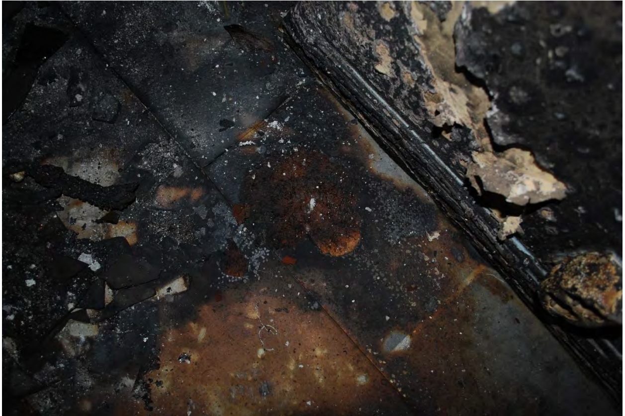
Foto 3 brandskador på golv vid vägg under fönstret
