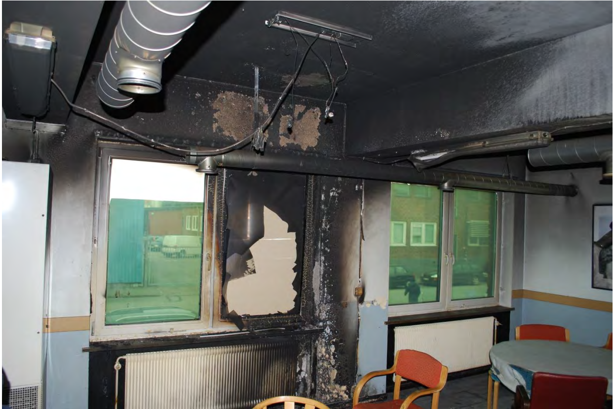
Foto 1 krossat fönster och brandskador på fönsterkarm och vägg
