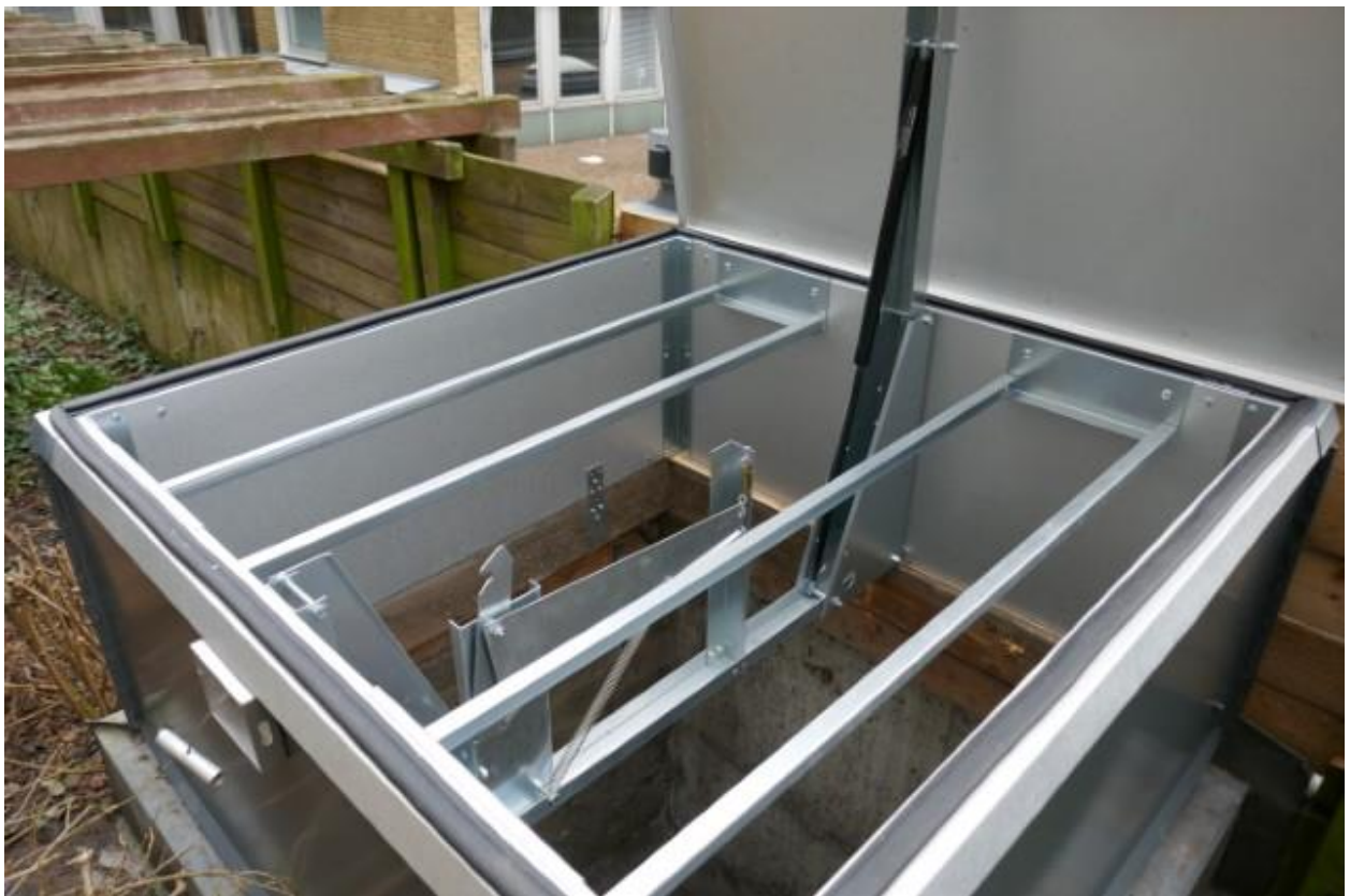
Bild 2. Luckan i uppfällt läge med tvärgående metallstänger som ska förhindra att någon faller ner genom luckan.
