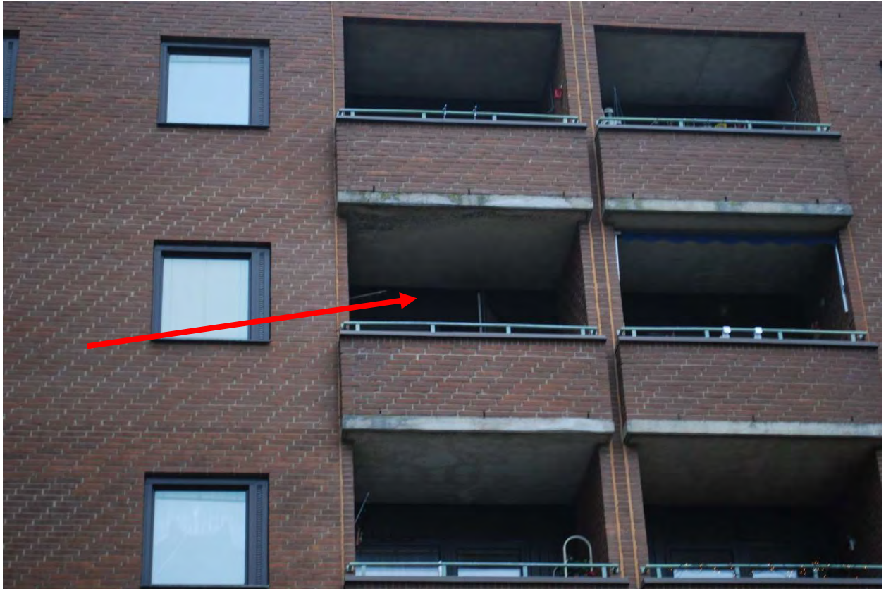
Bild 1. Tegel i fasaden och vid balkongerna, den drabbade lägenhetens balkong är vid pilen.
