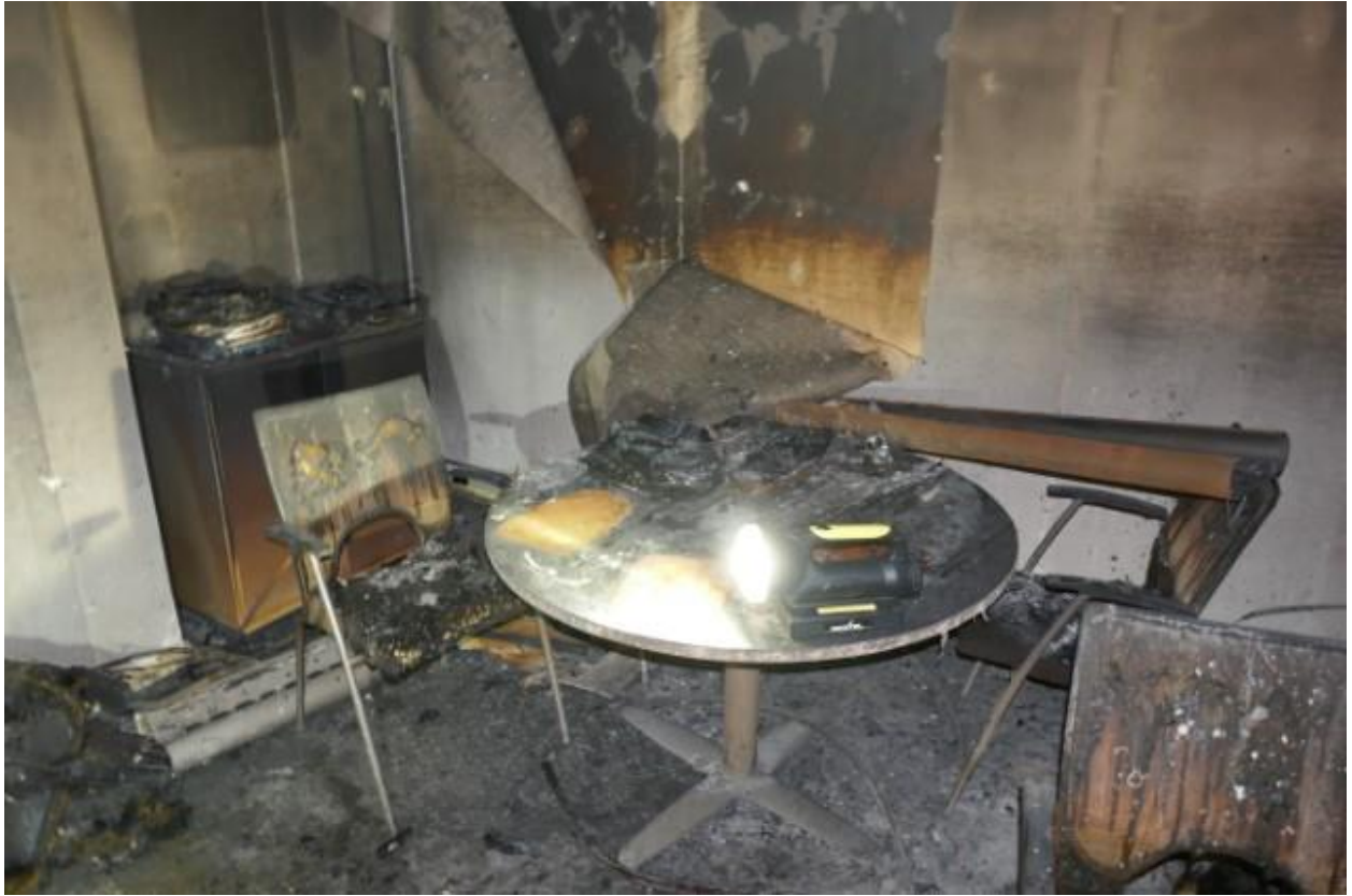
Foto 1. Brandskador på inredning och väggar i det drabbade rummet.
