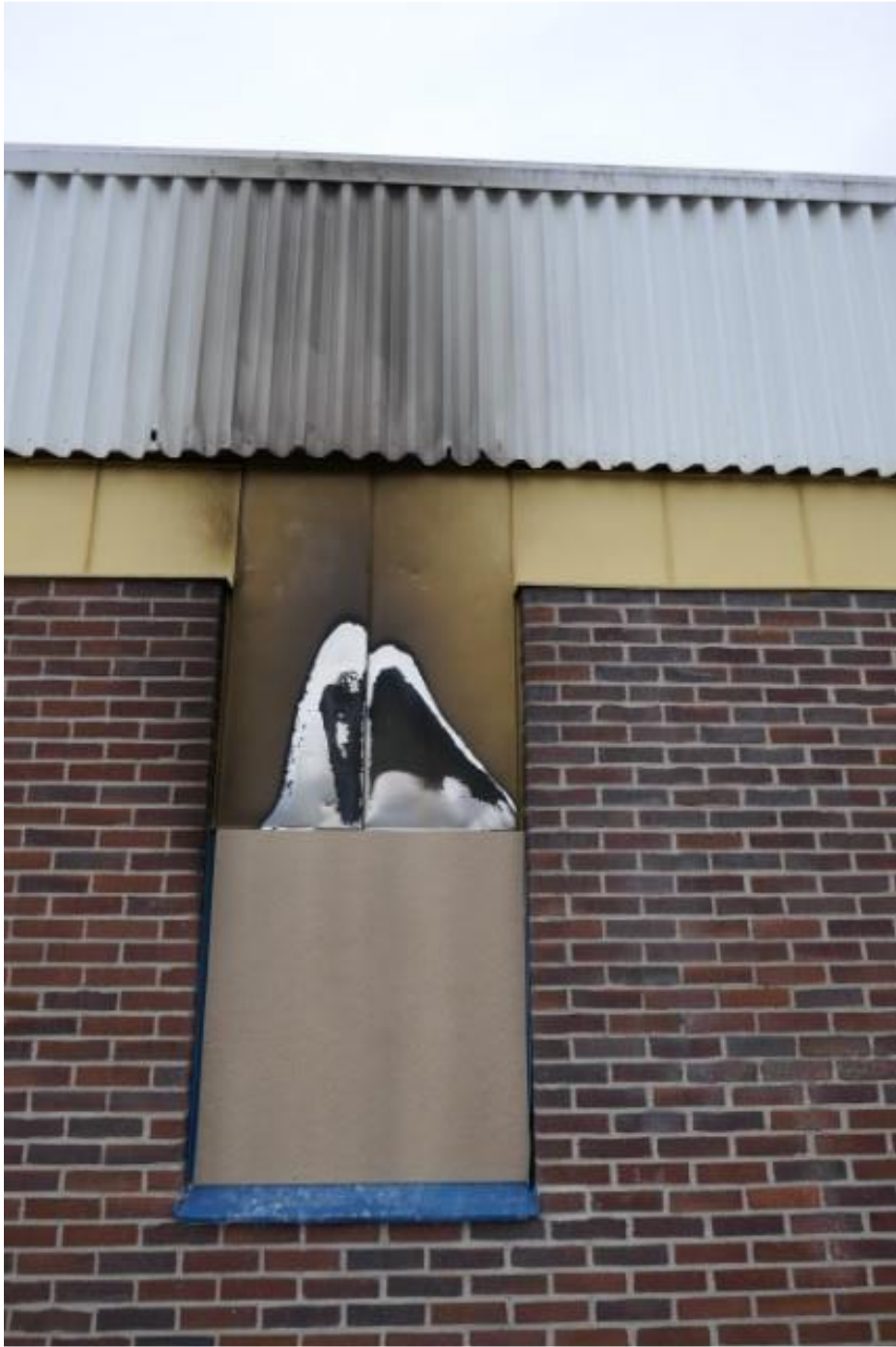
Foto 4. Sotskador på fasaden utanför det krossade fönstret.
