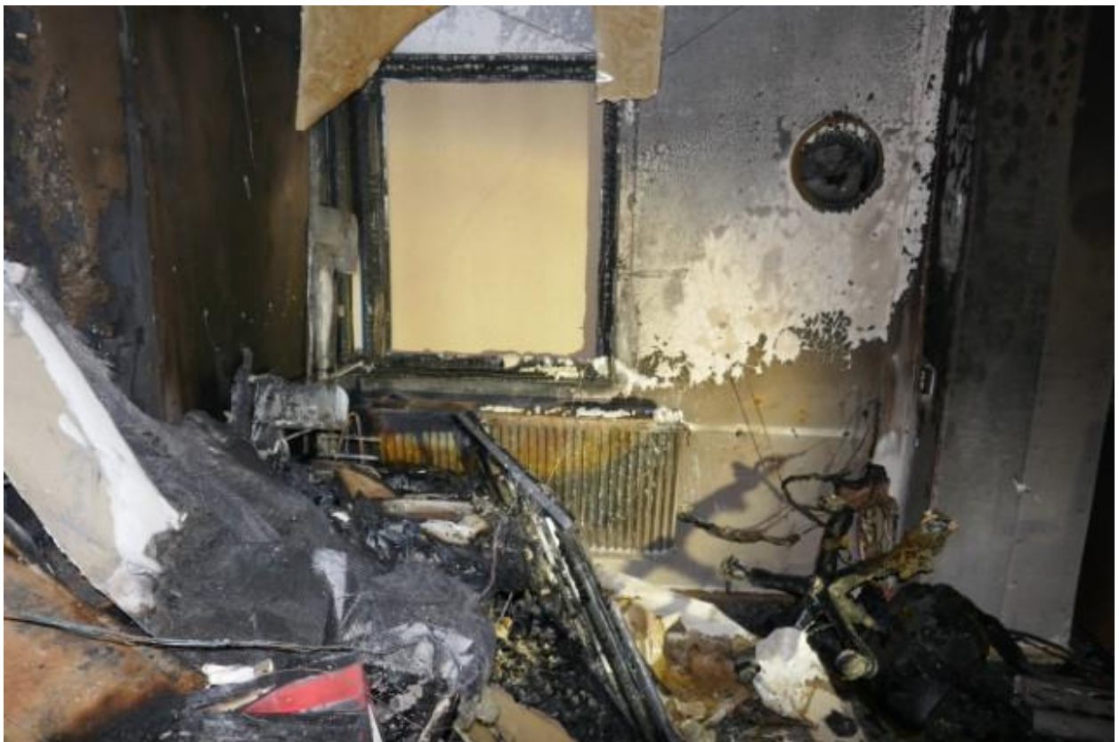
Foto 2. Det krossade fönstret inifrån rektorsexpeditionen. Fönstret är förspikat med en spånskiva.
