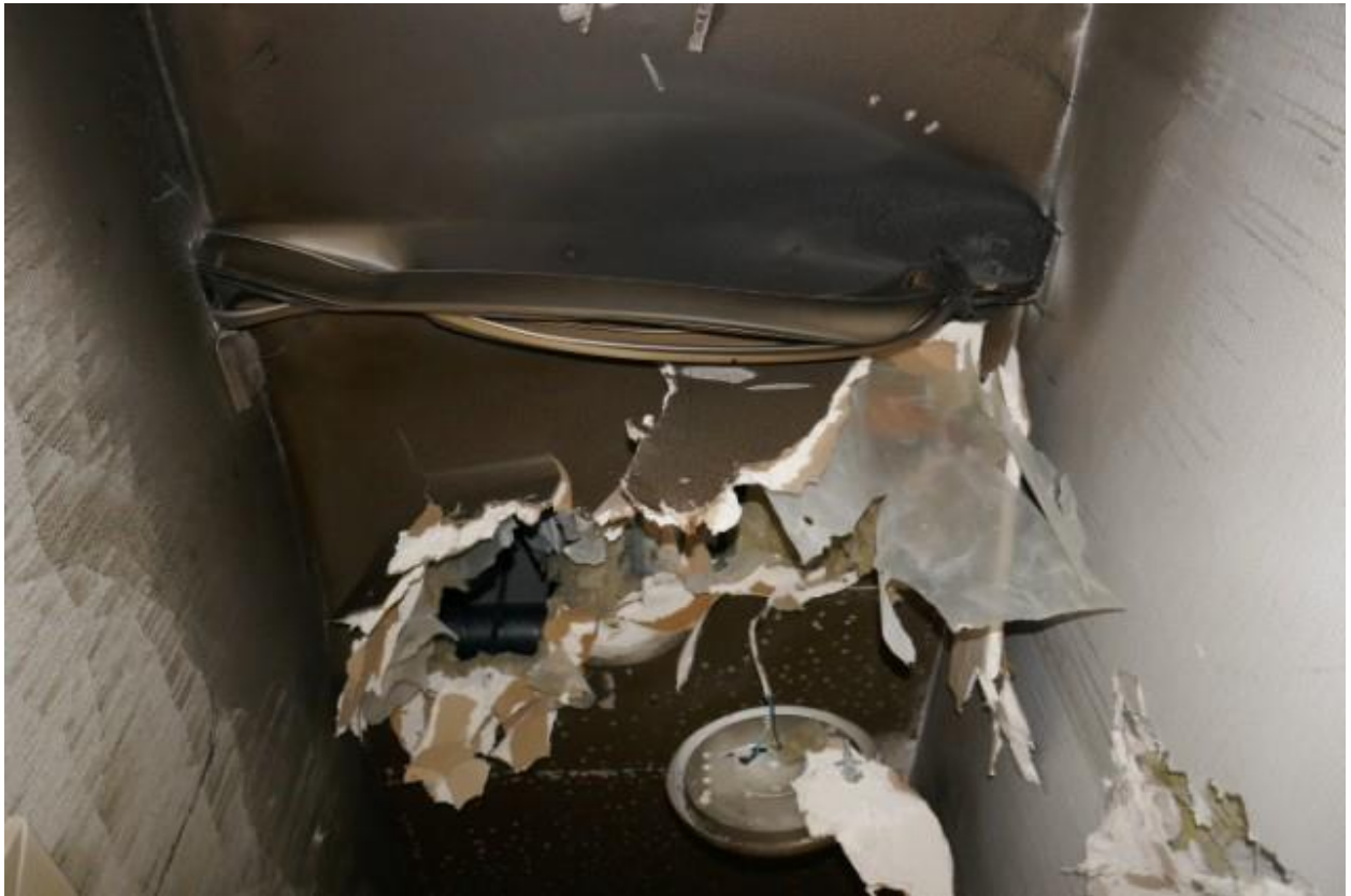
Foto 3. Skador i taket i rummet bredvid rektorsexpeditionen. Skadorna är delvis orsakade av räddningstjänsten.
