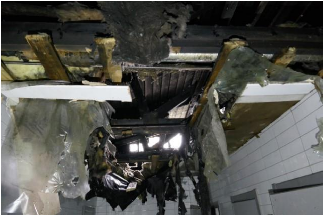
Foto 5. Brandskador i duschutrymme.
