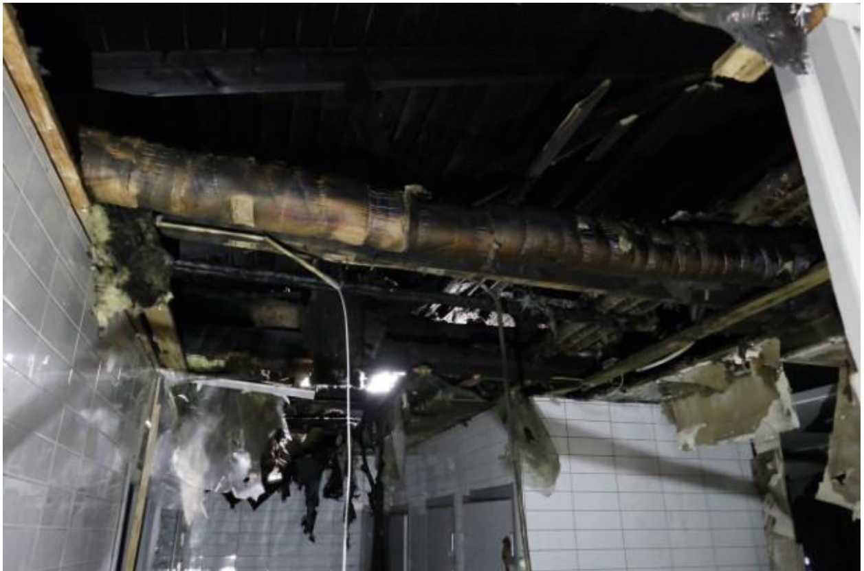
Foto 4. Brandskador i duschutrymme.
