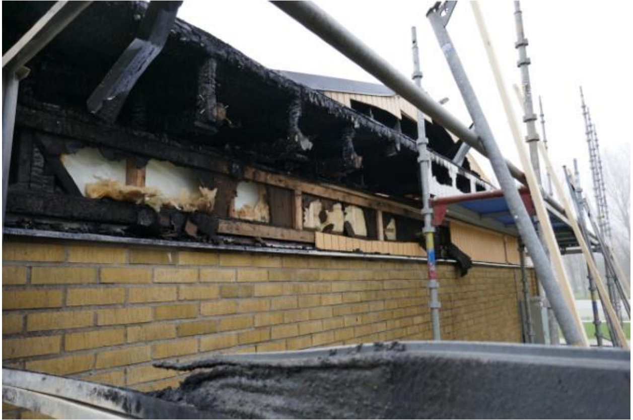
Foto 1. Brandskador i takfoten längs den södra gaveln.
