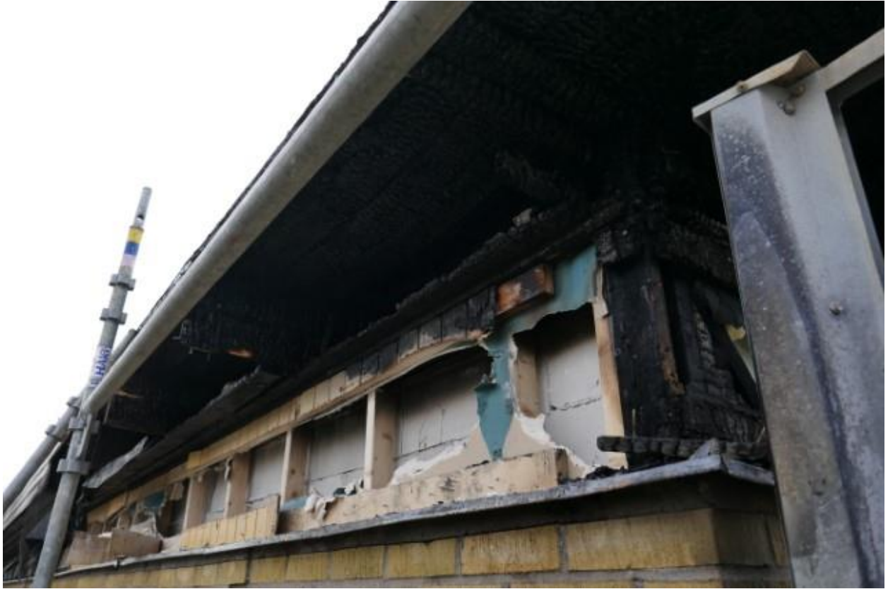
Foto 3. Brandskador i takfoten på den södra gaveln.
