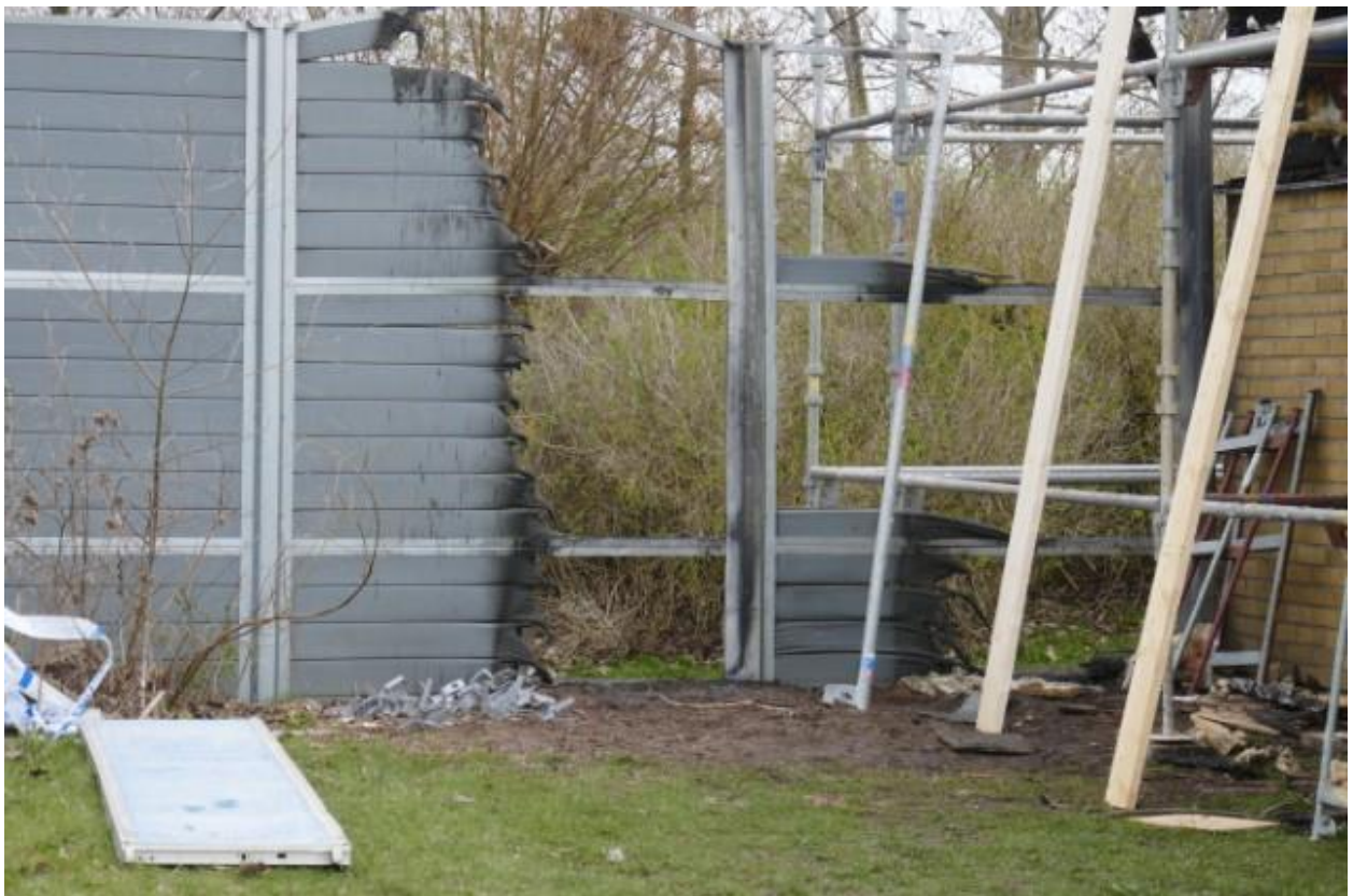
Foto 6. Brandskador på plank placerat nära byggnaden.
