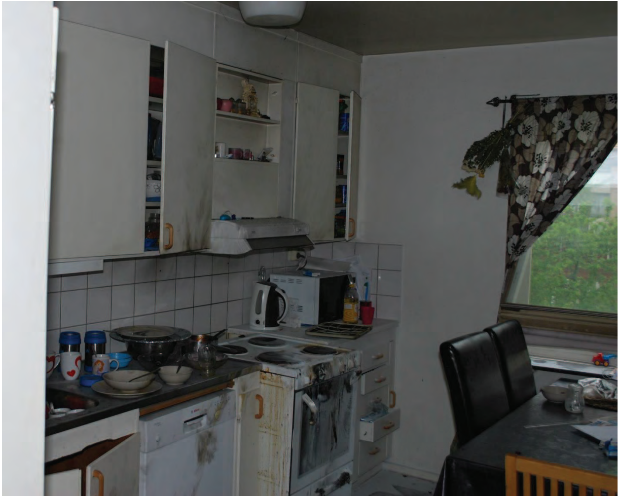
Foto 1 visar köket och spisen där det brunnit
