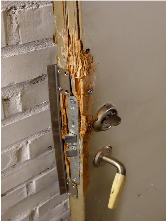
Foto 3. Brytskador på dörr in till förrådet.
