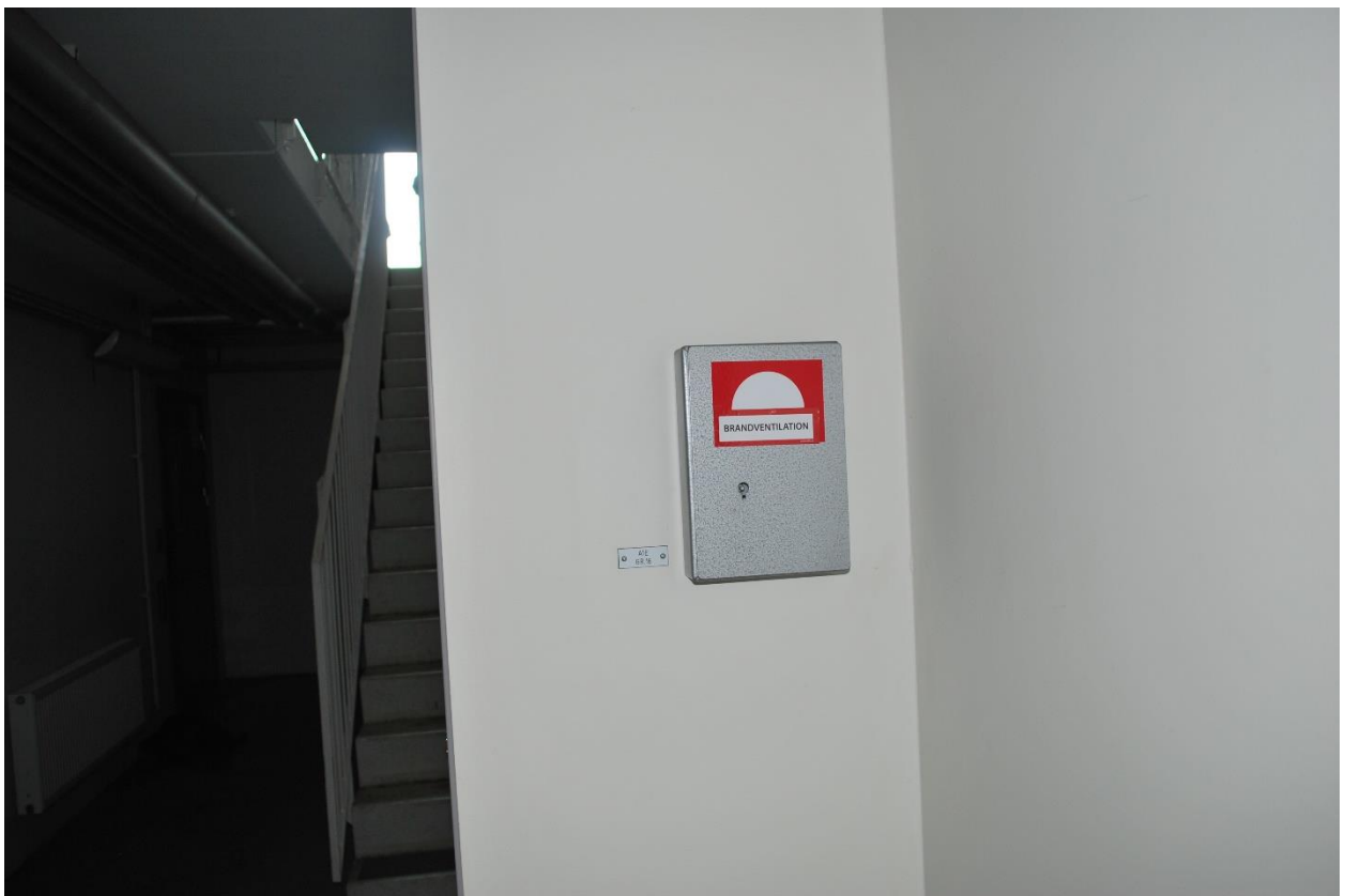
Foto nr 2. Manöverdon till brandventilation av källaren, dold i nisch.
