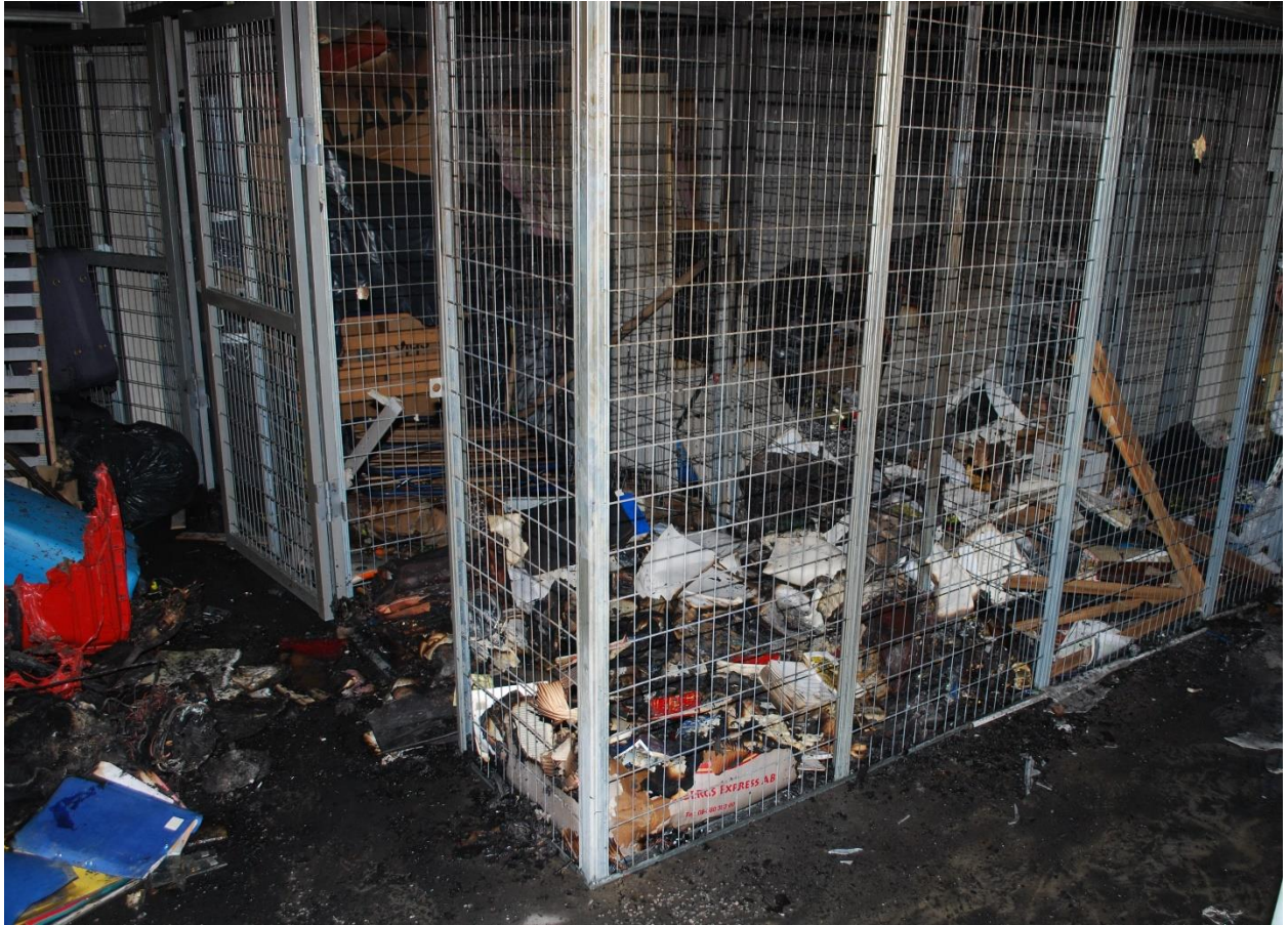
Foto nr 1, källarförråd där det brann.
