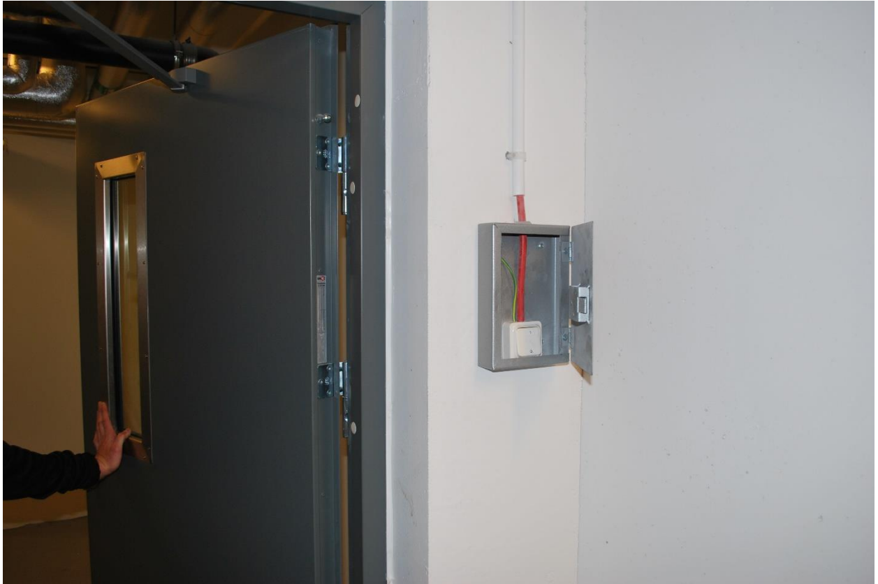
Foto nr 3. Manöverdon nr två till brandventilation källare.
