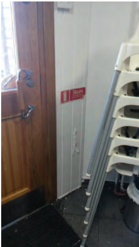
Foto 3. Handbrandsläckare saknades vid entrén till restaurangen.
