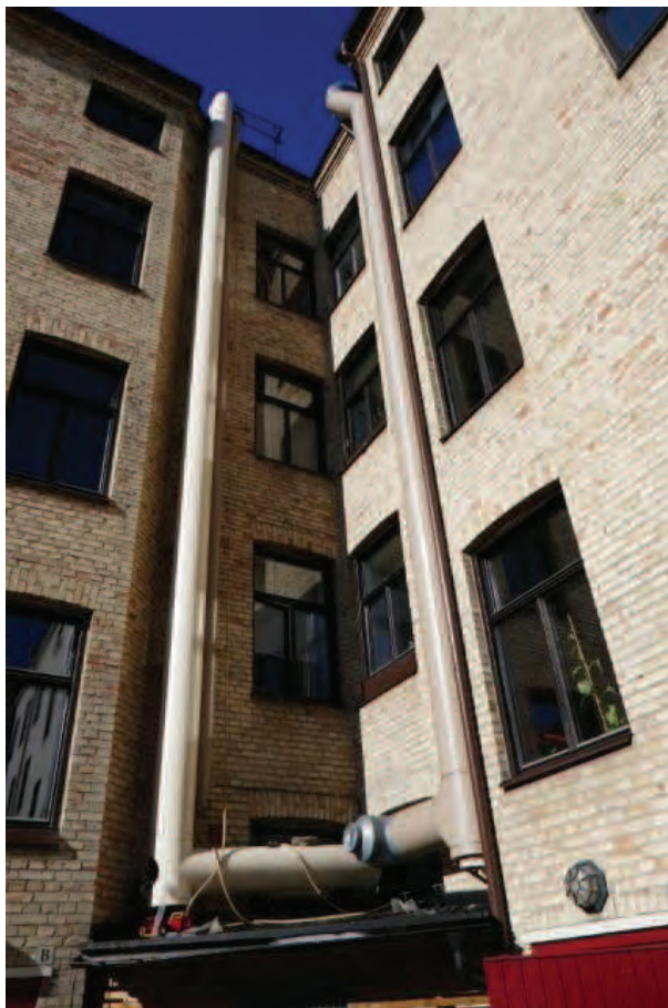
Foto 5. Röckkanalen löper längs fasaden på innergården.
