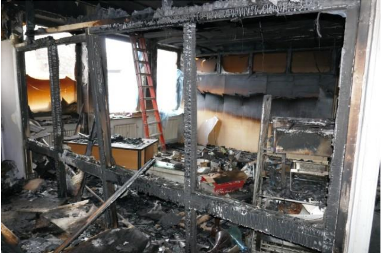
Foto 3. Kraftiga brandskador i förråd med fönster utmed Industrigatan.
