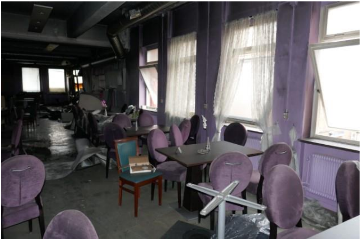
Foto 2. Brand- och rökskador i lokalen.
